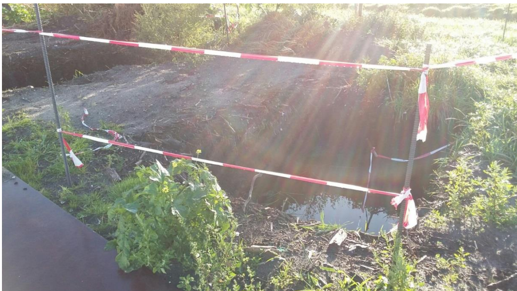
Figuur 6-6: Foto van proef 3 (2 dagen voor beproeven), hieruit blijkt dat ten tijde van de proef er grondwater aanwezig was ter plaatse van de ontgraving. De grondwaterstand is daarmee ongeveer gelijk aan het niveau van de ontgraving (ca. NAP -2 m) of hoger.
