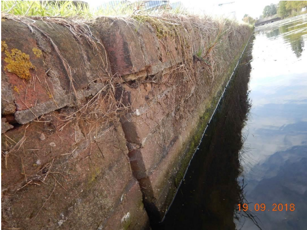
Rollaag los en afgeschoven, vermoedelijke deformatie kademuur:
