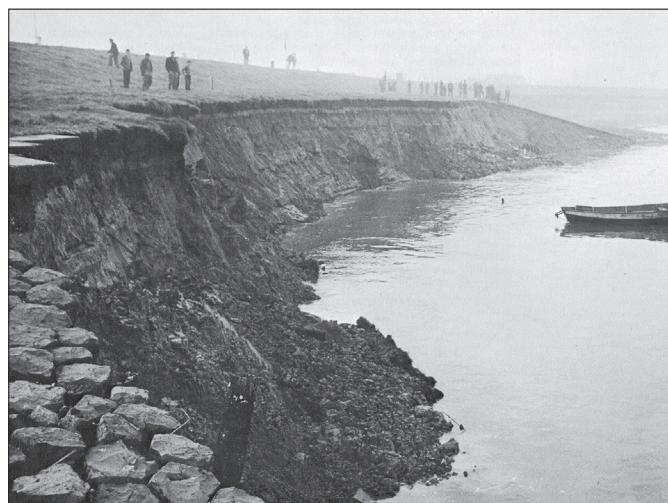
↑ Figuur 1 Inbessing met schade aan de dijk bij een oeverval
