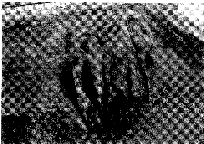
Beschadigde damwandplank (bron: Ministerie van Verkeer en Waterstaat)
