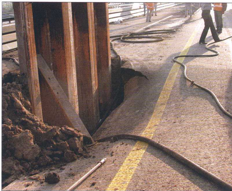
■ Figuur 2: Voorbeeld van opgetreden zakkingen bij het intrillen van damwanden
