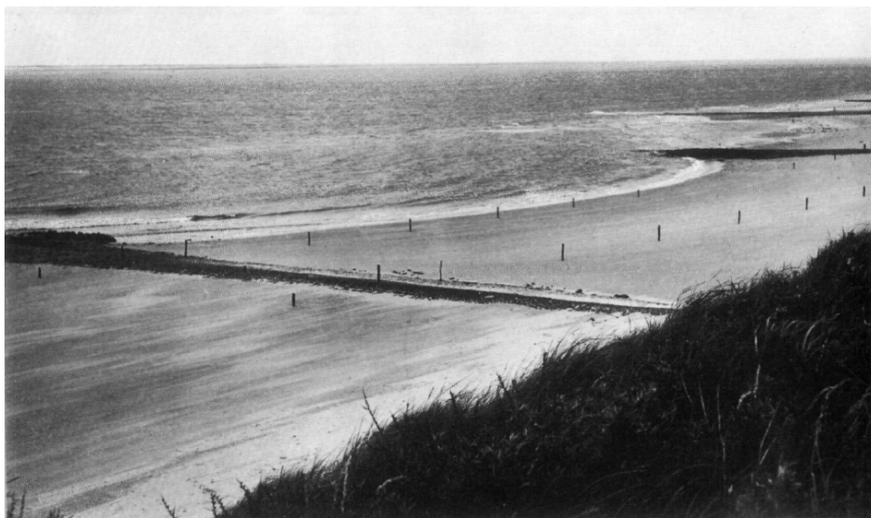
Figuur 4-4. Strandval van 4 april 1958 in het Noorderstrand bij Scharendijke. Hierbij verdween 0,4 ha strand tussen de strandhoofden no. 13 (links) en 14 (rechts, deels beschadigd) (Wilderom, 1964).
