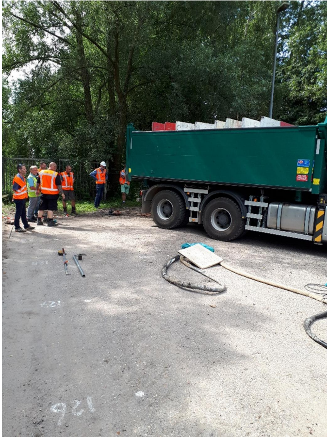
Figuur 4.15 Op het sterk opgebolde asfalt (zie eerdere 600 mm) nabij punt 329 is een wiel van een vrachtauto geplaatst
