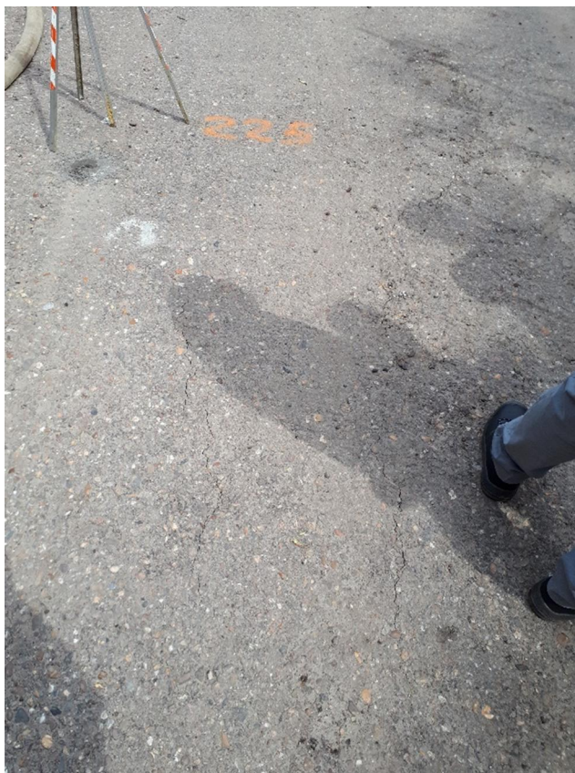
Figuur 4.14 Scheurenpatroon na injecteren op punt 225: kleinere scheuren in het asfalt nabij de punten 125, 126, 225 en 226
