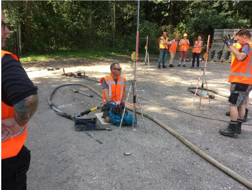
Figuur 4.9. Het proces van onderhogen: in het midden wordt geïnjecteerd. Tevens zijn de statieven ten behoeve van de lasermetingen te zien
