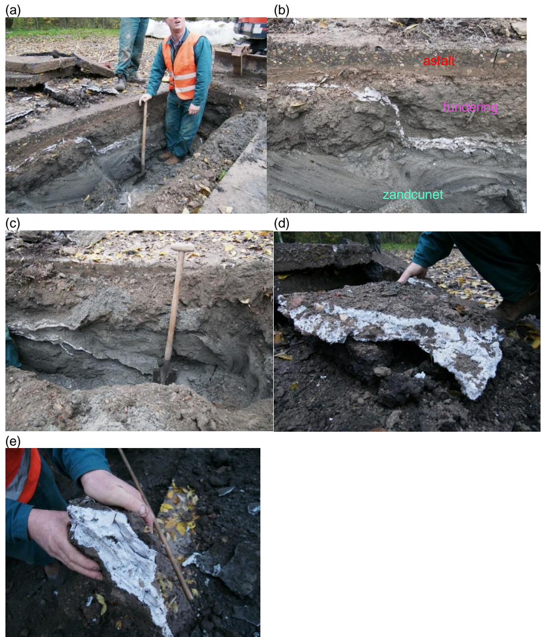
Figuur 4.18 Schollen van door Uretek geïnjecteerd 2 componenten expansiehars: (a) kanaal met hars vanaf de bodem (rechts) tot onder het asfalt (links). Te zien is ook de kromming in de asfaltlaag t.g.v. het onderhogen; (b) detail van (a); (c) Schollen aan andere zijde kuil; (d) ontgraven grote lichtblauwe schol met hars; (e) een schol met hars van dichtbij
