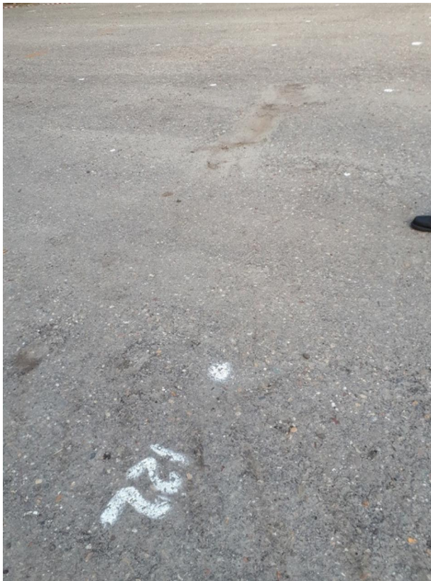
Figuur 4.5 In het midden boven het deel waar het asfalt ontbreekt, gelegen tussen punten 222, 322, 223 en 323
