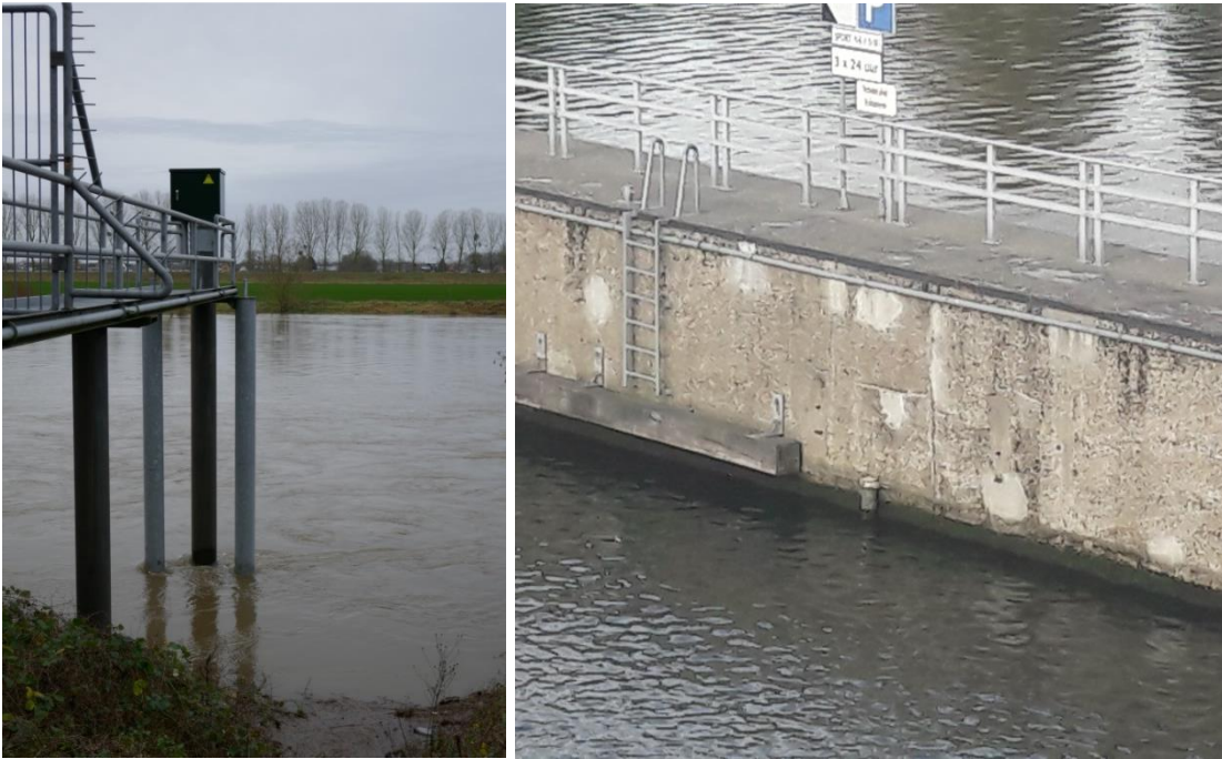
Foto: Links: Meetstation LMW_Elsloo. Rechts: Diver benedenstrooms van St. Servaasbrug
