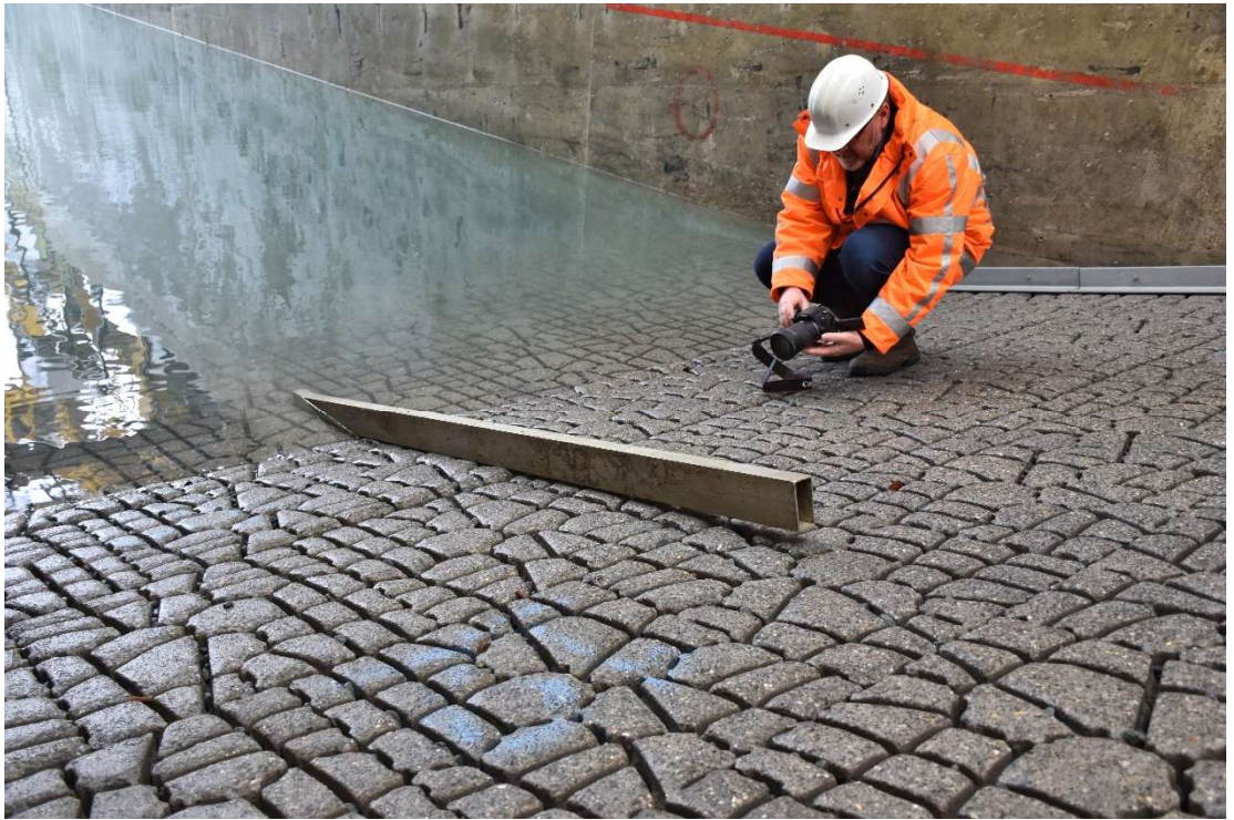
Fig. E-12, Inspectie van het talud na proef RXL-08 (een deel van de oneffenheden was reeds bij de aanleg aanwezig)
