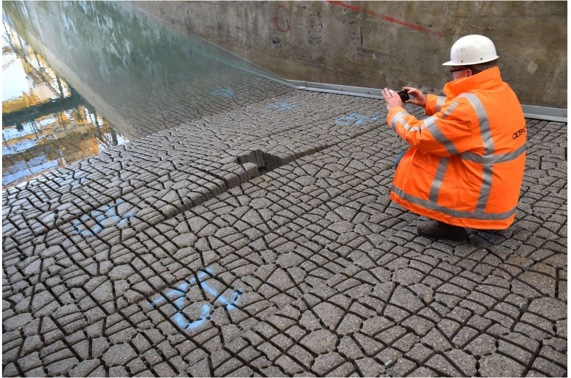
Fig. E-20, Schade na proef RXL-13
