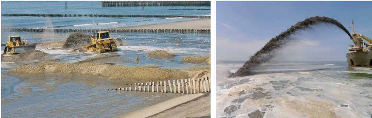
Figuur 3-3 Foto's van de aanleg van een strandsuppletie (links) en het opspuiten, of rainbowen, van een vooroeversuppletie (rechts). Bron: natuurlijkveilig.nl
