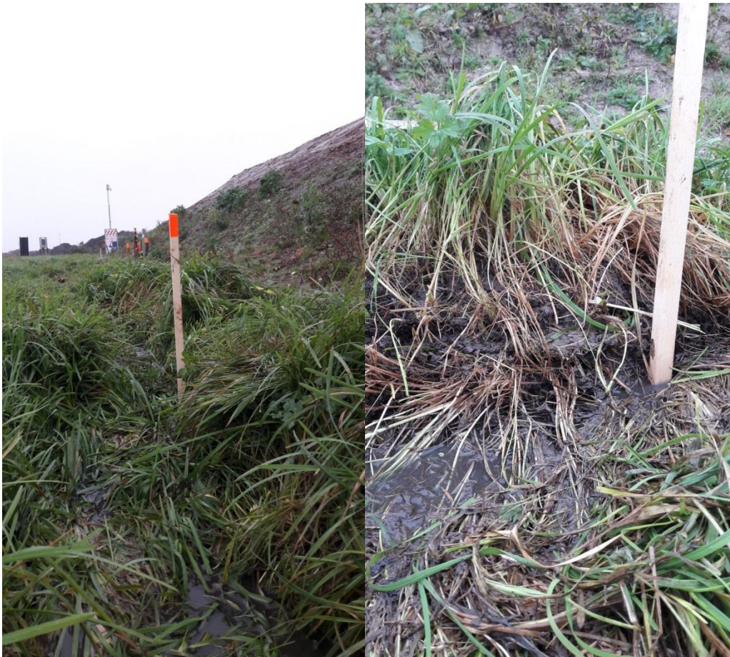
Foto C.1 Scheurvorming in binnendijks maaiveld groene proefdijk dd 21 november 2017
