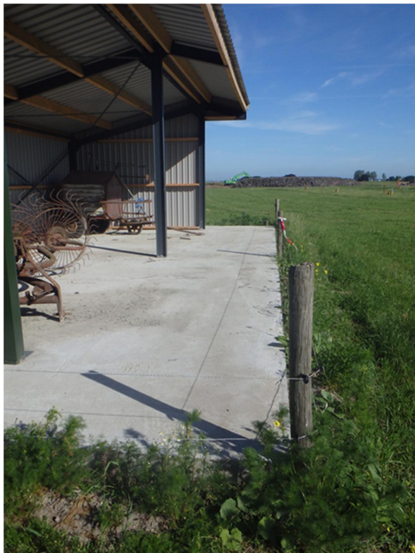
Figuur D.7: Close-up betonvloer schuur (richting noordwesten genomen)
