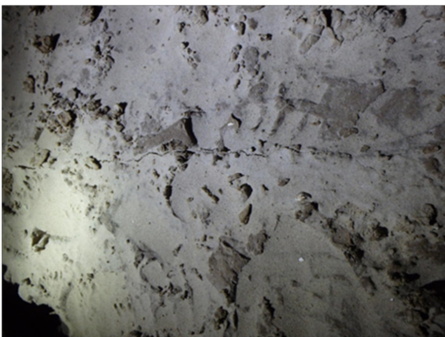
Foto 3.12 Scheuren op kruin aan waterbassin-zijde van containers (infiltratie tot NAP + 2,50 m)
