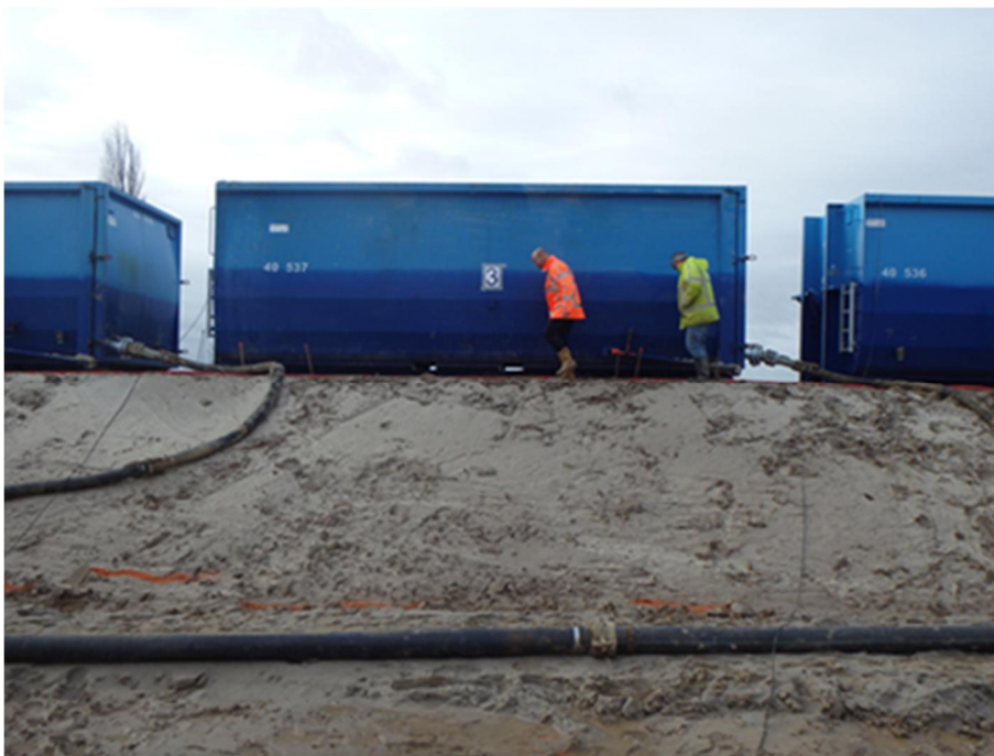
Foto 3.21 Scheuren in talud aan waterbassin-zijde van container #3 (infiltratie tot NAP + 2,50 m)
