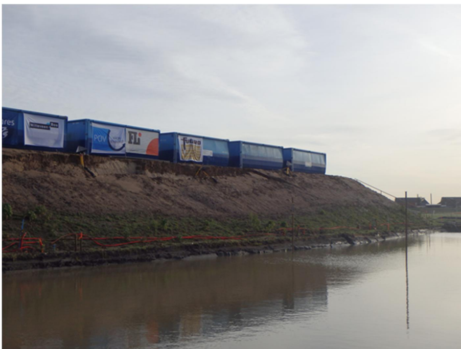
Foto 3.28 Doorgaande scheurvorming in kruin voor middelste containers (zijaanzicht)
