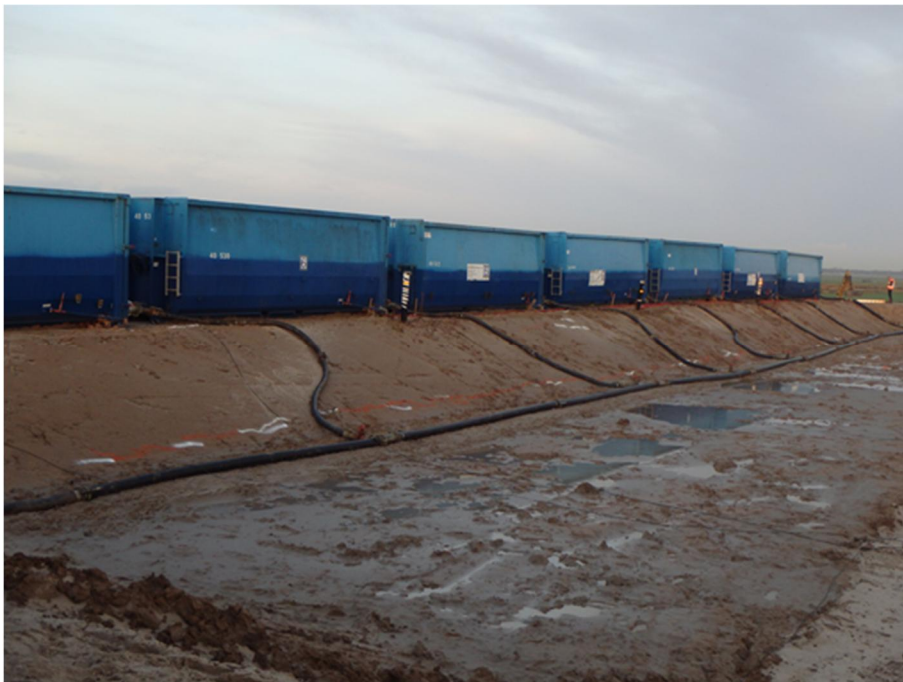
Foto 3.22 Scheurvorming in talud aan waterbassin-zijde van containers (infiltratie tot NAP + 2,85 m)
