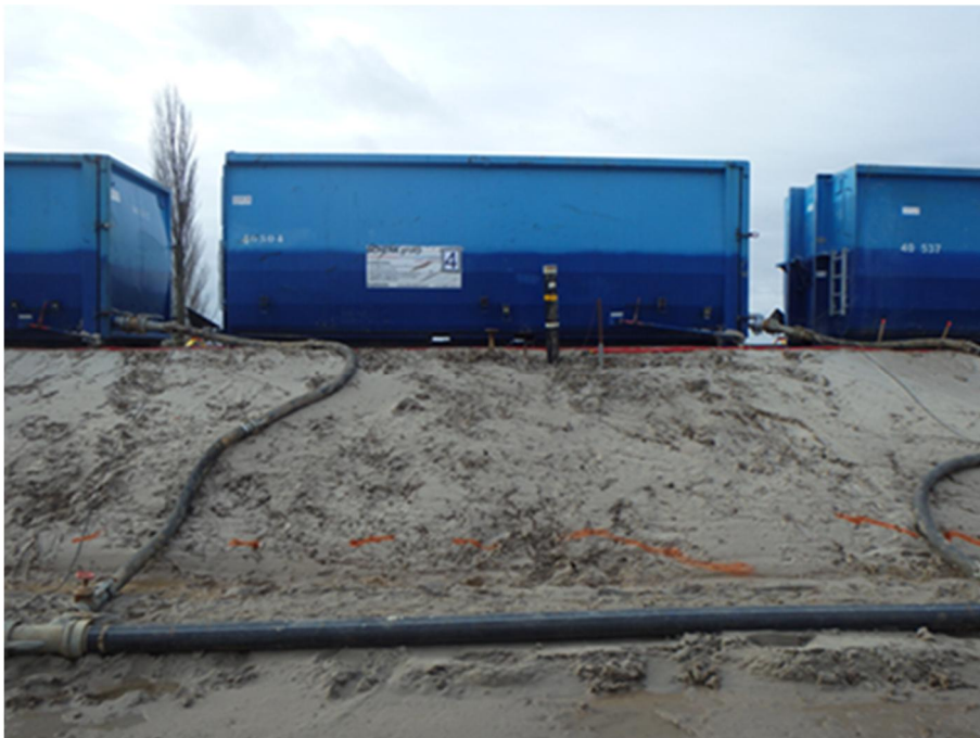
Foto 3.20 Scheuren in talud aan waterbassin-zijde van container #4 (infiltratie tot NAP + 2,50 m)
