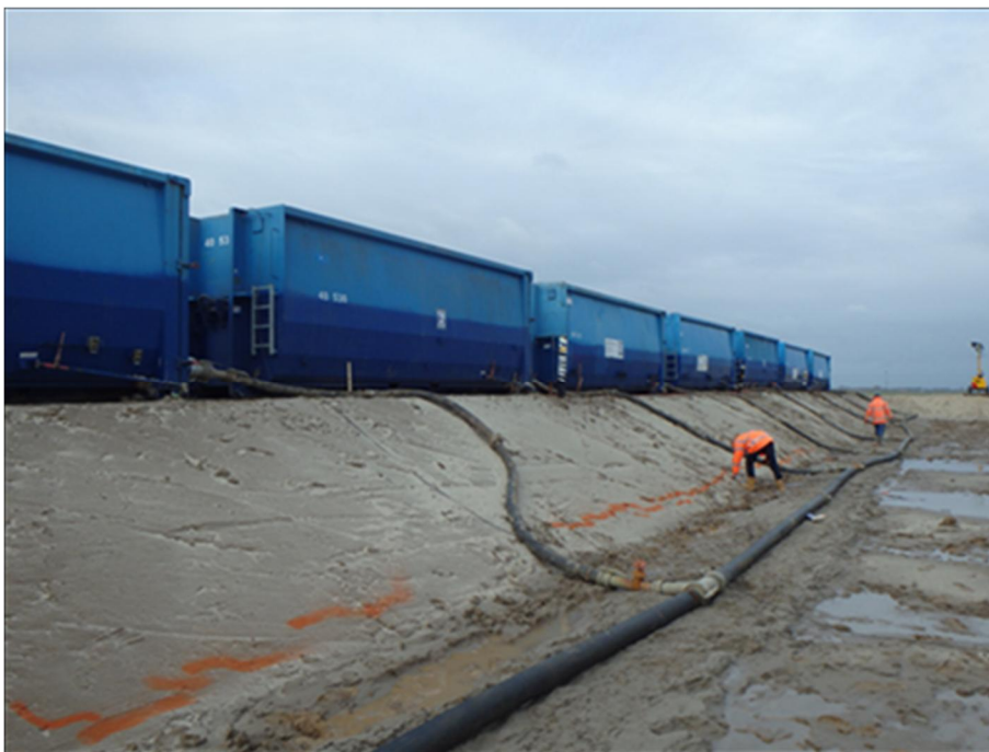
Foto 3.15 Scheuren in talud aan waterbassin-zijde van containers (infiltratie tot NAP + 2,50 m)
