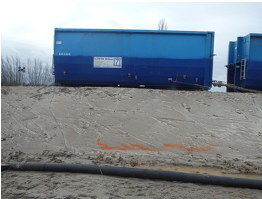
Foto 3.16 Scheuren in talud aan waterbassin-zijde van container #7 (infiltratie tot NAP + 2,50 m)
