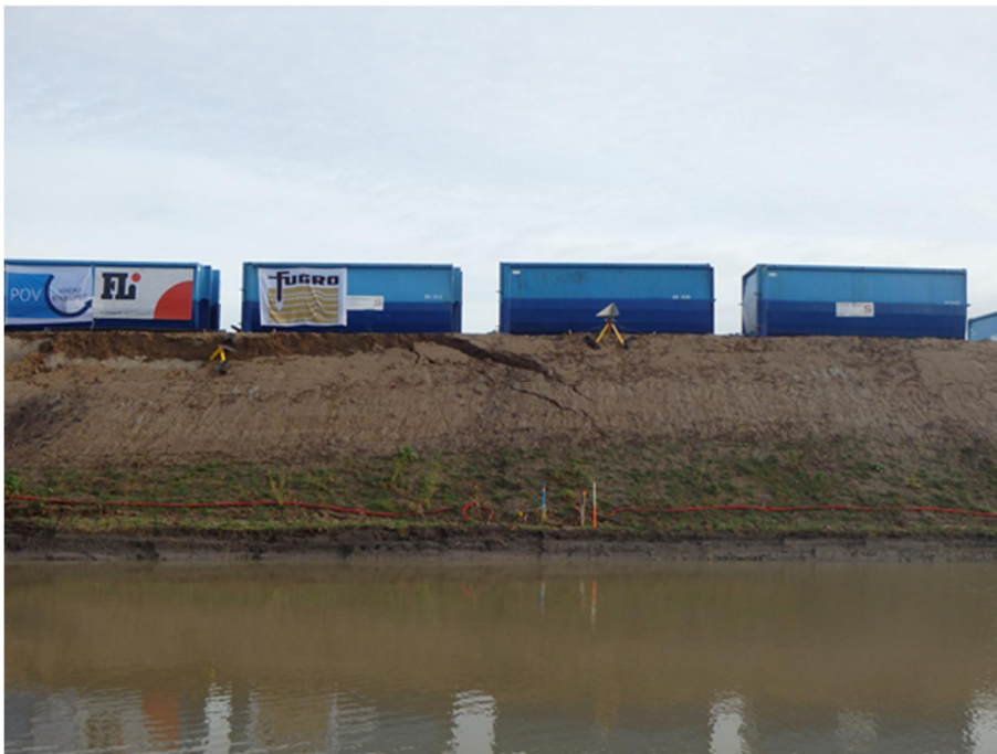
Foto 3.27 Doorgaande scheurvorming in kruin voor middelste containers (vooraanzicht)
