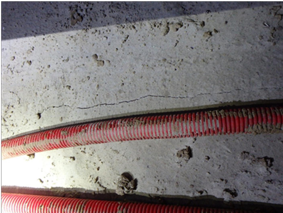
Foto 3.13 Scheuren op kruin aan waterbassin-zijde van containers (infiltratie tot NAP + 2,50 m)
