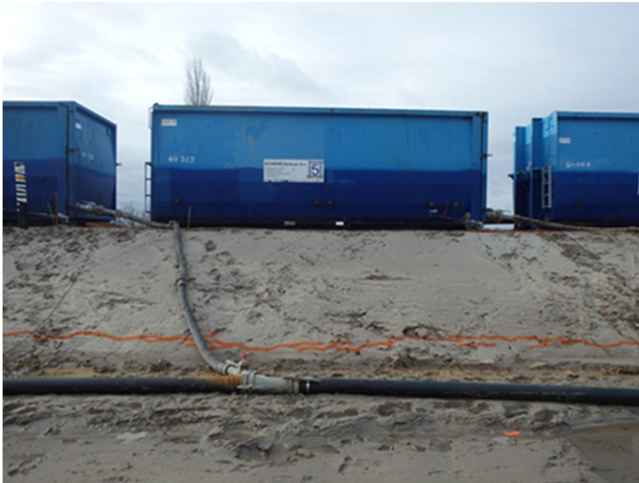
Foto 3.19 Scheuren in talud aan waterbassin-zijde van container #5 (infiltratie tot NAP + 2,50 m)
