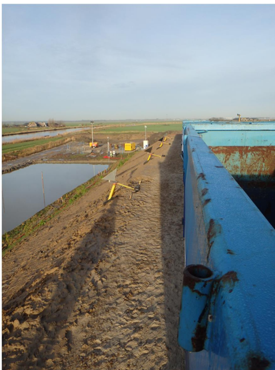
Foto 3.26 Scheurvorming in kruin voor middelste container (vullen containers)
