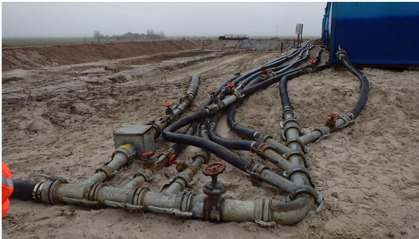
Foto 4.16 Overzicht afsluiters voor vulleiding containers en waterbassin vanaf zuidelijke kopse kant
