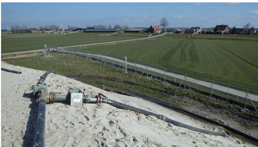
Foto 4.15 Overzicht infiltratie leiding naar zandkern binnentalud (links) en zandkern blauwe dijk (rechts), inclusief debietmeters en afsluiters
