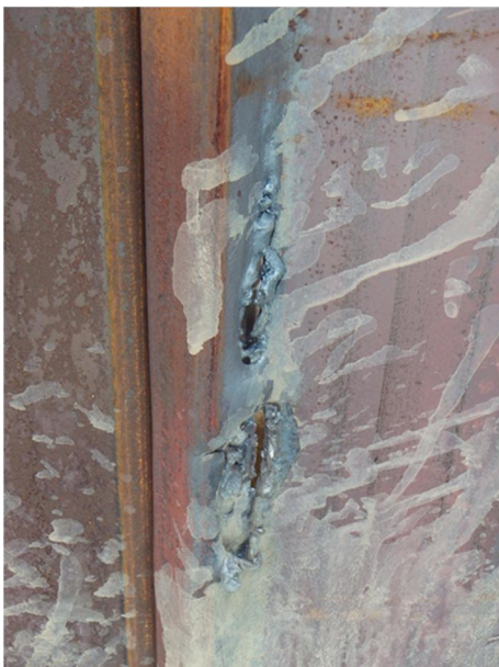
Foto 4.12 Voorbeeld schade aan damwandslot tgv installeren
