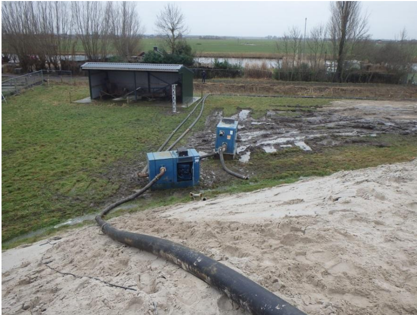
Foto 3.5 Betsy pomp en de aanvoerleiding naar de buffercontainer
