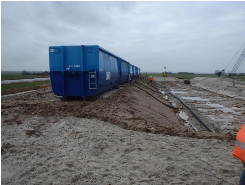
Foto 3.6 Containers met aan de onderzijde de langsleiding met vulleiding naar de container waarvan elke vulleiding is voorzien van een afsluiter (de containers worden van onderaf gevuld)
