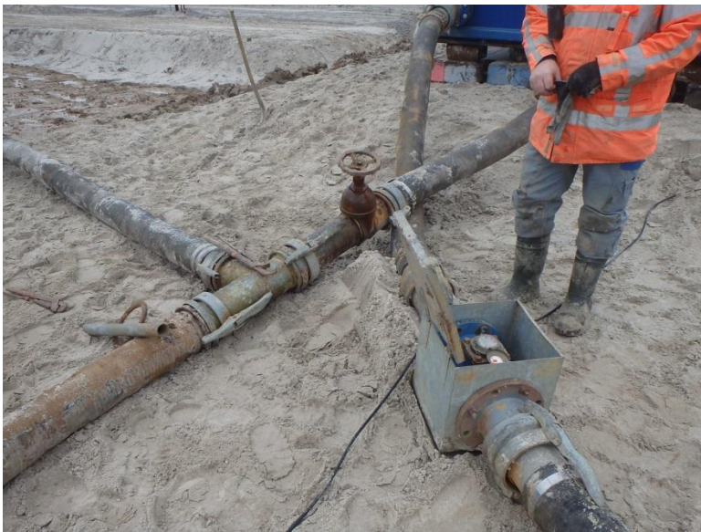
Foto 3.4 Overzicht van de vulleiding en de infiltratie leiding naar de zandkern (niet op de foto, de afsluiter naar de langsleiding voor het vullen van de containers, en niet aanwezig de afsluiter achter de debietmeter op de infiltratie leiding
