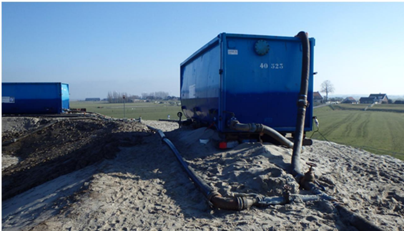
Foto 4.13 Verhoogde plaatsing buffercontainer op zuidelijke kopse kant
