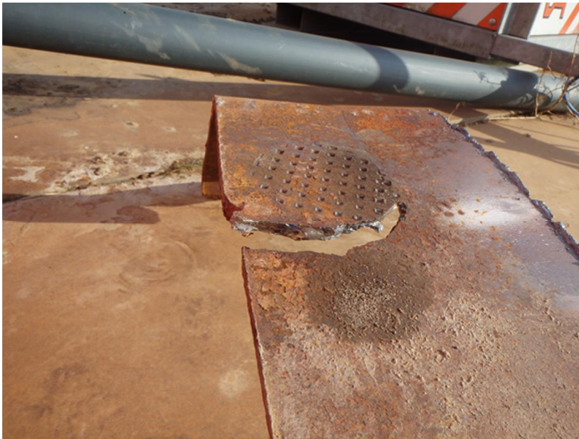
Foto 4.8 Schade aan plankkop tpv klemmen op afgebrand stuk damwand
