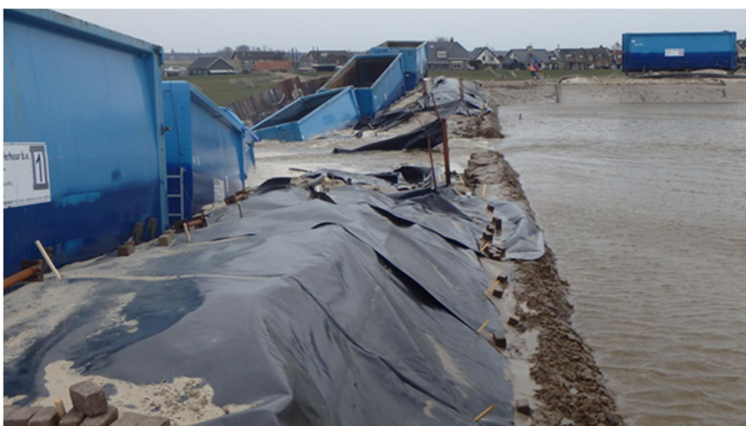
Foto 4.32 Bezwijken blauwe proefdijk; overslaand water vanuit waterbassin (boven noord)
