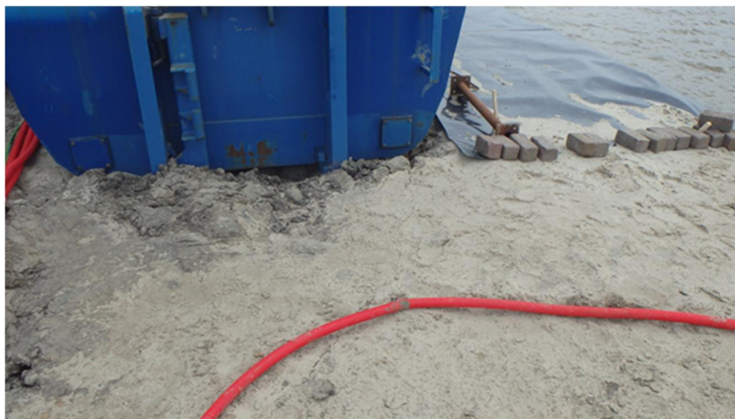
Foto 4.25 Zichtbare scheurvorming naast container noordelijke kopse kant
