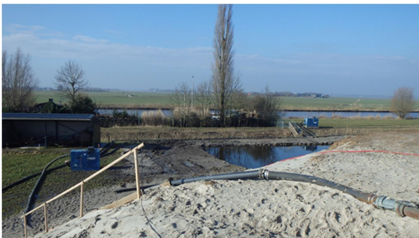
Foto 4.8 Oorspronkelijke opstelling parallel geschakelde pompen (links naar buffer, rechts naar ontgraving)
