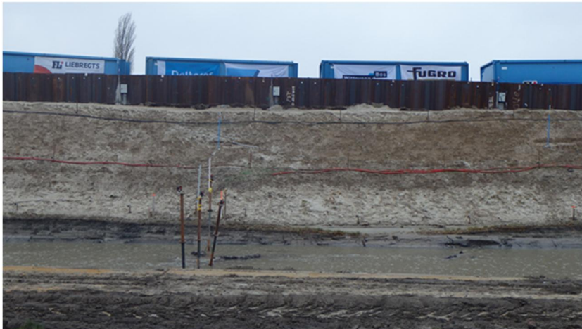
Foto 4.28 Start bezwijken blauwe proefdijk; boven water uitkomen glijdvlak
