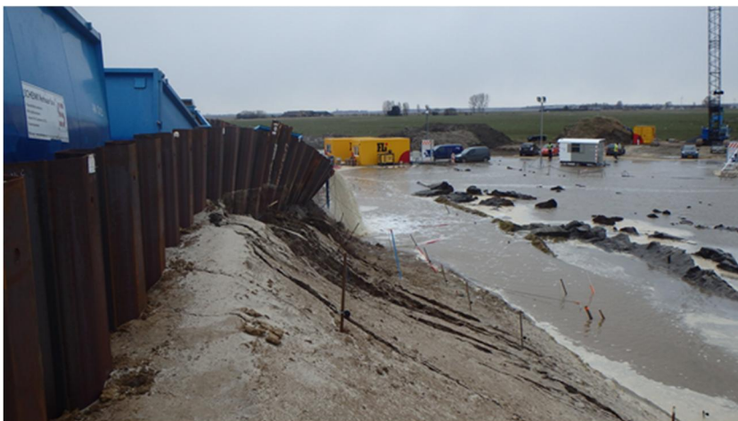
Foto 4.34 Bezwijken blauwe proefdijk; overslaand water vanuit waterbassin (onder zuid)
