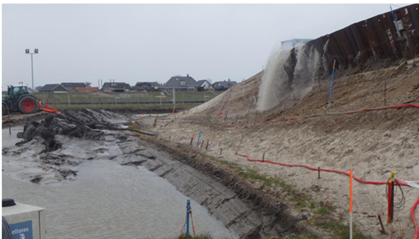
Foto 4.31 Bezwijken blauwe proefdijk; overslaand water vanuit waterbassin (onder)
