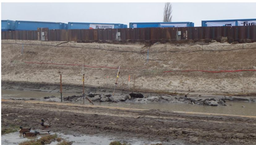
Foto 4.29 Start bezwijken blauwe proefdijk; zakking binnentalud
