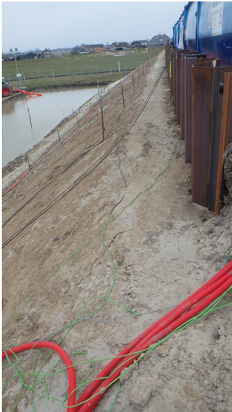
Foto 4.26 Zichtbare scheurvorming naast damwand noordelijke kopse kant
