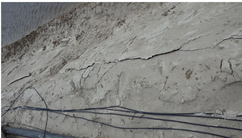
Foto 4.18 Scheuren in talud waterbassin tijdens opvoeren belasting containers (stap 7)
