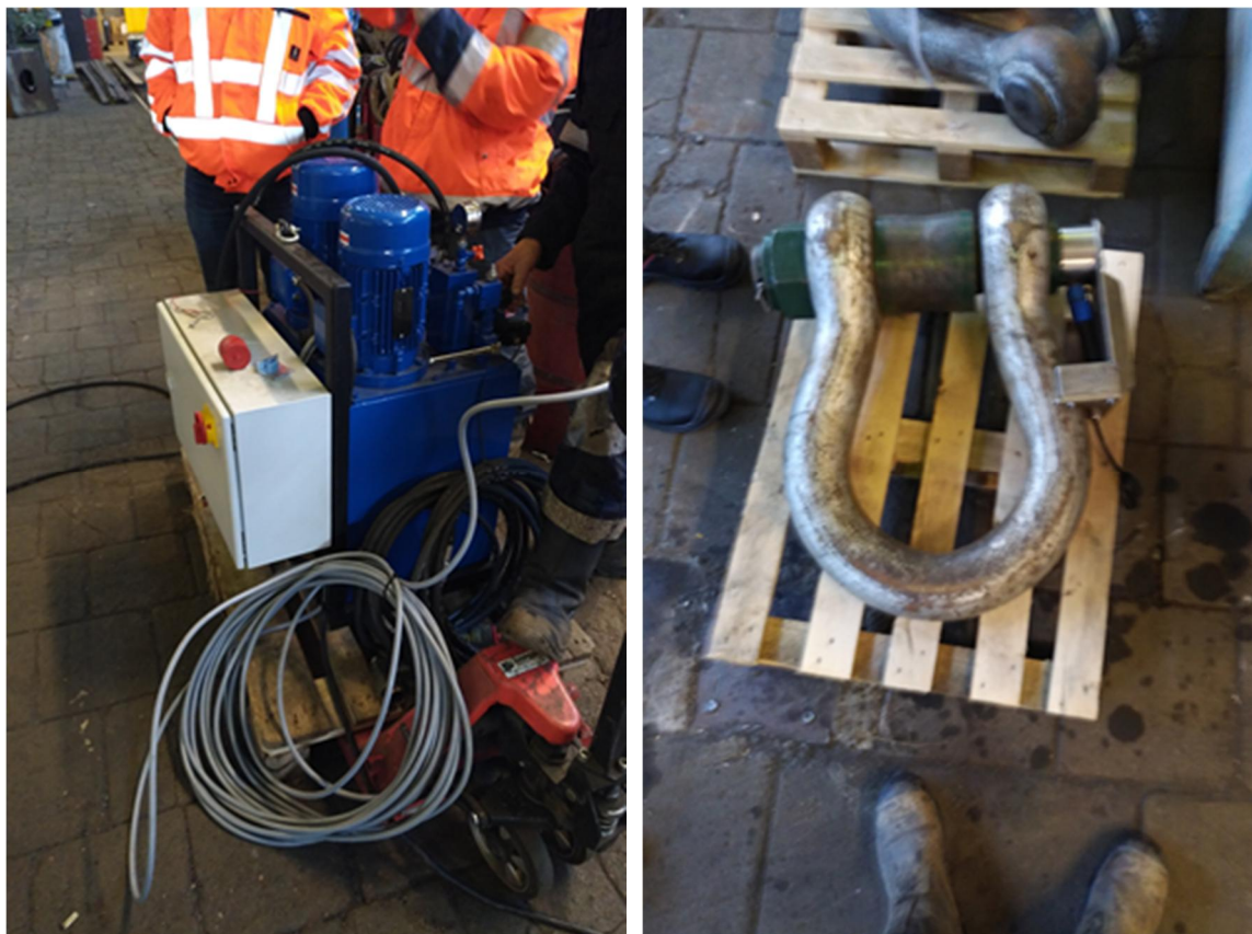
Afbeelding 2.5: Links hydraulische unit, rechts trekkracht meter
