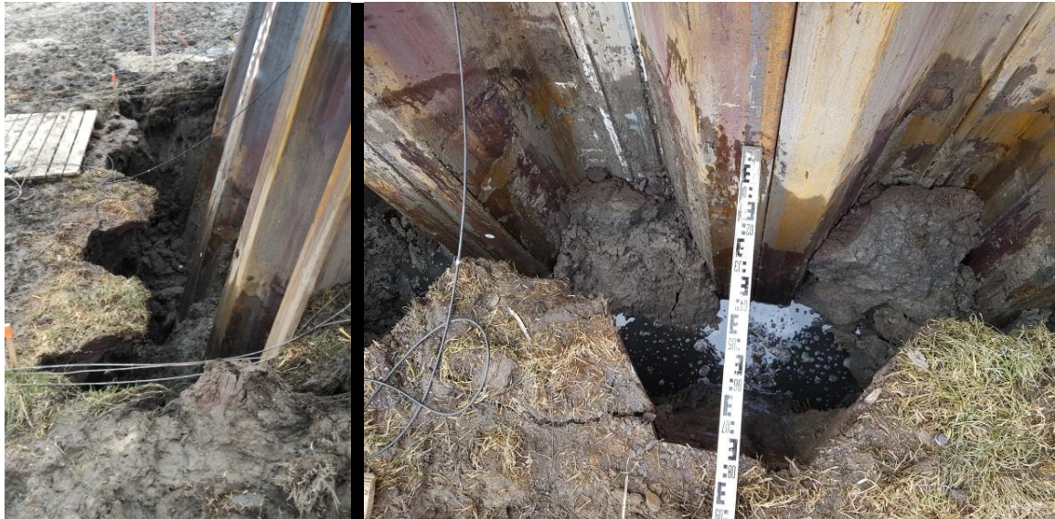
Figuur 3.4 Spleetvorming achter damwand (AZ26)
