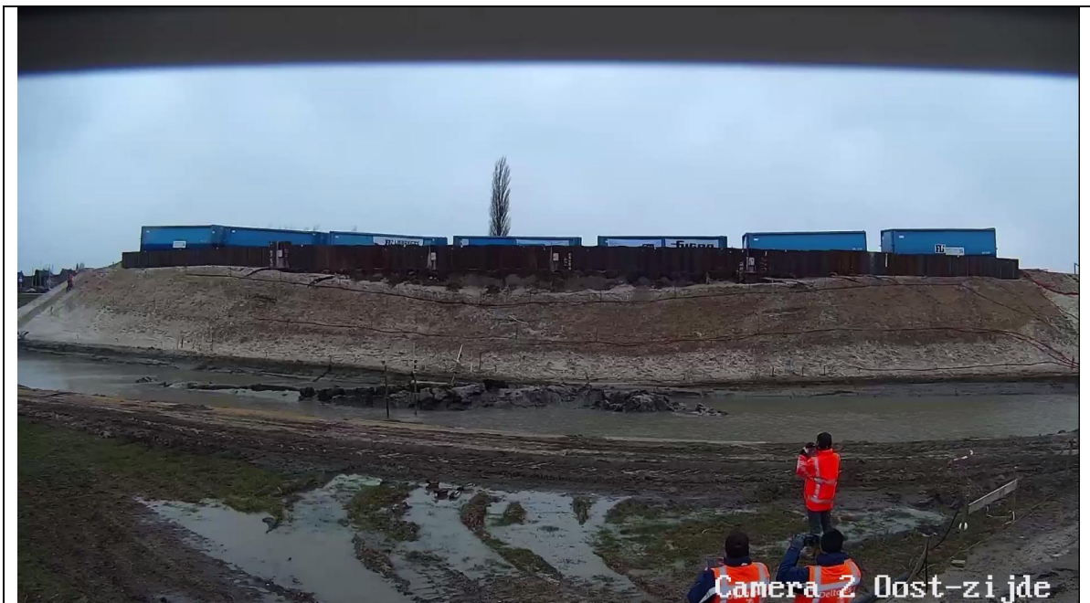
11 sec: Doorgaande verplaatsing van het talud voor de damwand in verhoogde snelheid. Ook is duidelijk te zien dat de verplaatsing in het midden het grootst is. De containers achter de damwand zijn ook ca 1m gezakt
