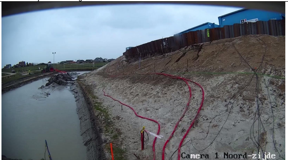
13 sec: Doorgaande verplaatsing van het talud. De afschuiving is nu volledig boven water en dus 2m omhoog gedrukt. Tevens is te zien dat de afschuiving over een grotere breedte plaatsvindt.
