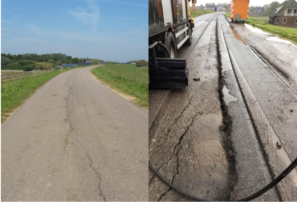
Figuur D.6 Lengtescheur in dijklichaam links, nabij Culemborg na uitvoering dijkversterking Hagestein – Opheusden bestaande uit een stabiliteitsberm aan beide zijden van de dijk, foto augustus 2017, circa 1 à 2 jaar na uitvoering dijkversterking. Rechts in het traject Kinderdijk – Schoonhovenseveer, foto september 2017
