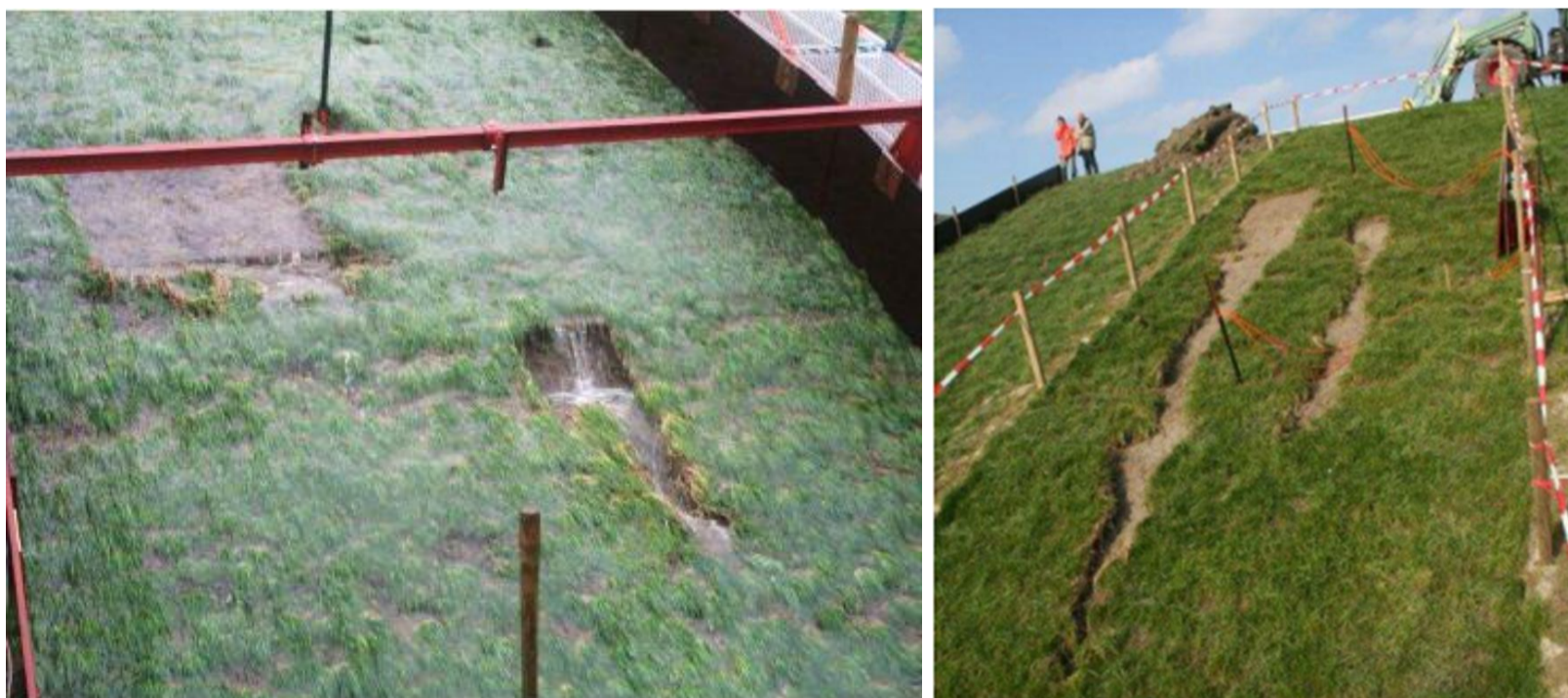
Figuur 7.2 Voorbeeld van overslagproeven op een beschadigd talud. Links: initieel aangebrachte schade. Rechts: afgestroopt gras beneden de initiële schade na afloop van de proef. (bron:[32]).
