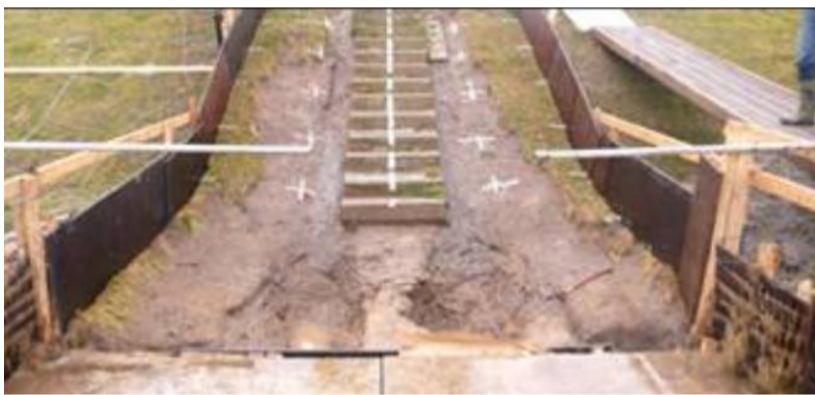
Figuur 5.3 Schade als gevolg van stroomconcentratie na zeer grote overslagdebieten (6 uur, 50 l/s/m)
