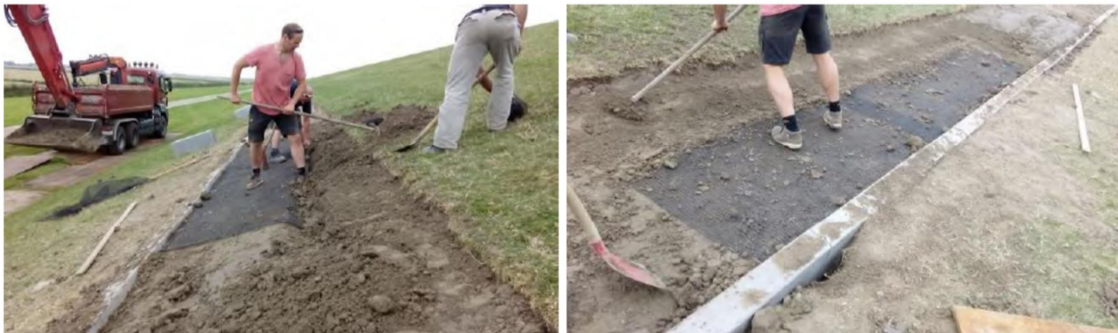
Figuur J.12 Impressie van het aanbrengen van een doorgroeitextiel bij de pilotsectie op het binnentalud van de Waddenzeedijk
