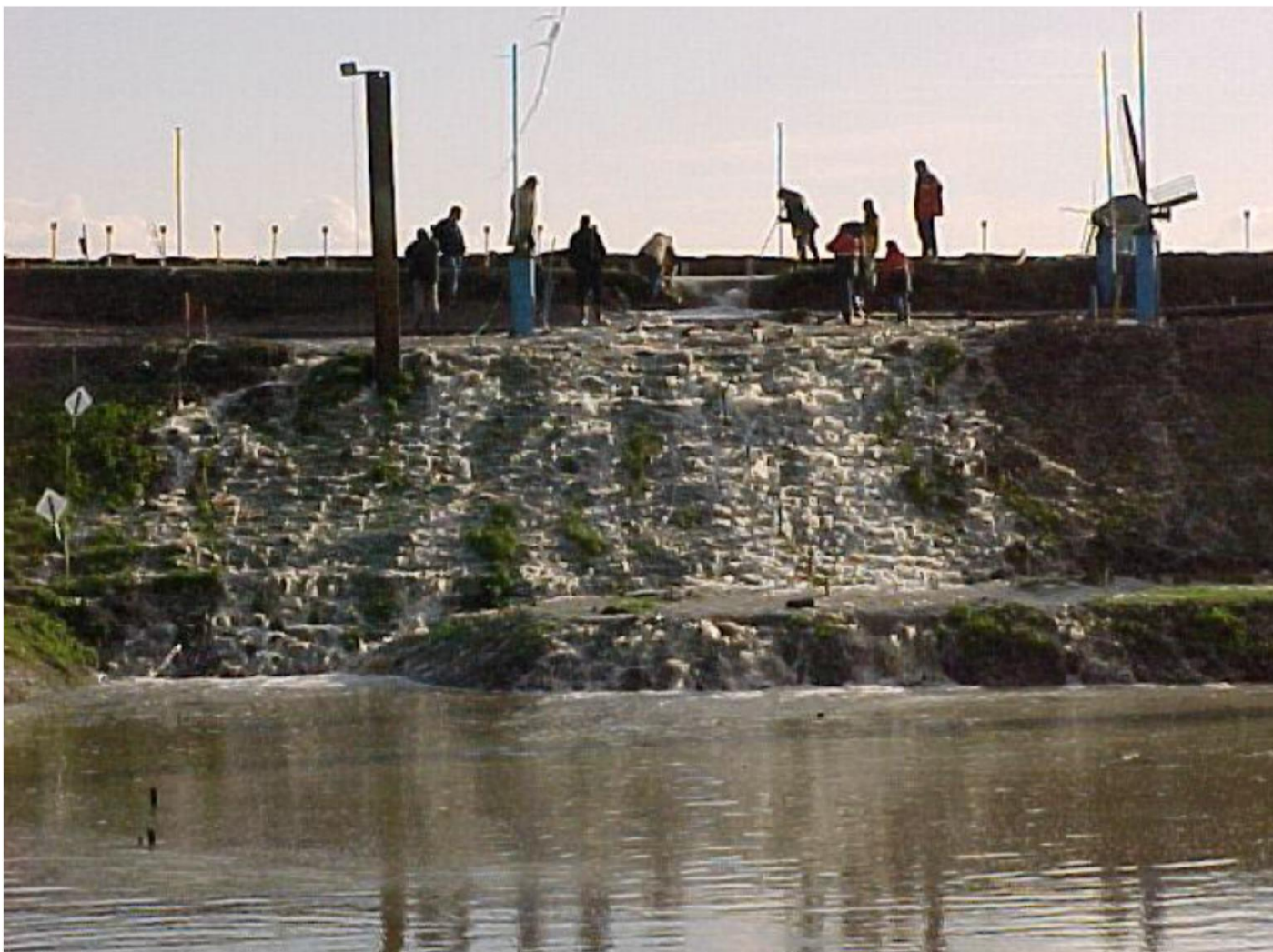
Figuur 4.8 Afschuifproef Bergambacht waar na afloop van de afschuiving is gekeken in hoeverre het afgeschoven binnentalud nog bestand was tegen erosie door overloop.
