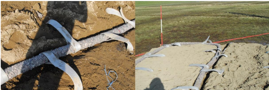
Figuur 3.14 Detail van de aansluiting van de verticale drainstrips op de horizontale drainage
