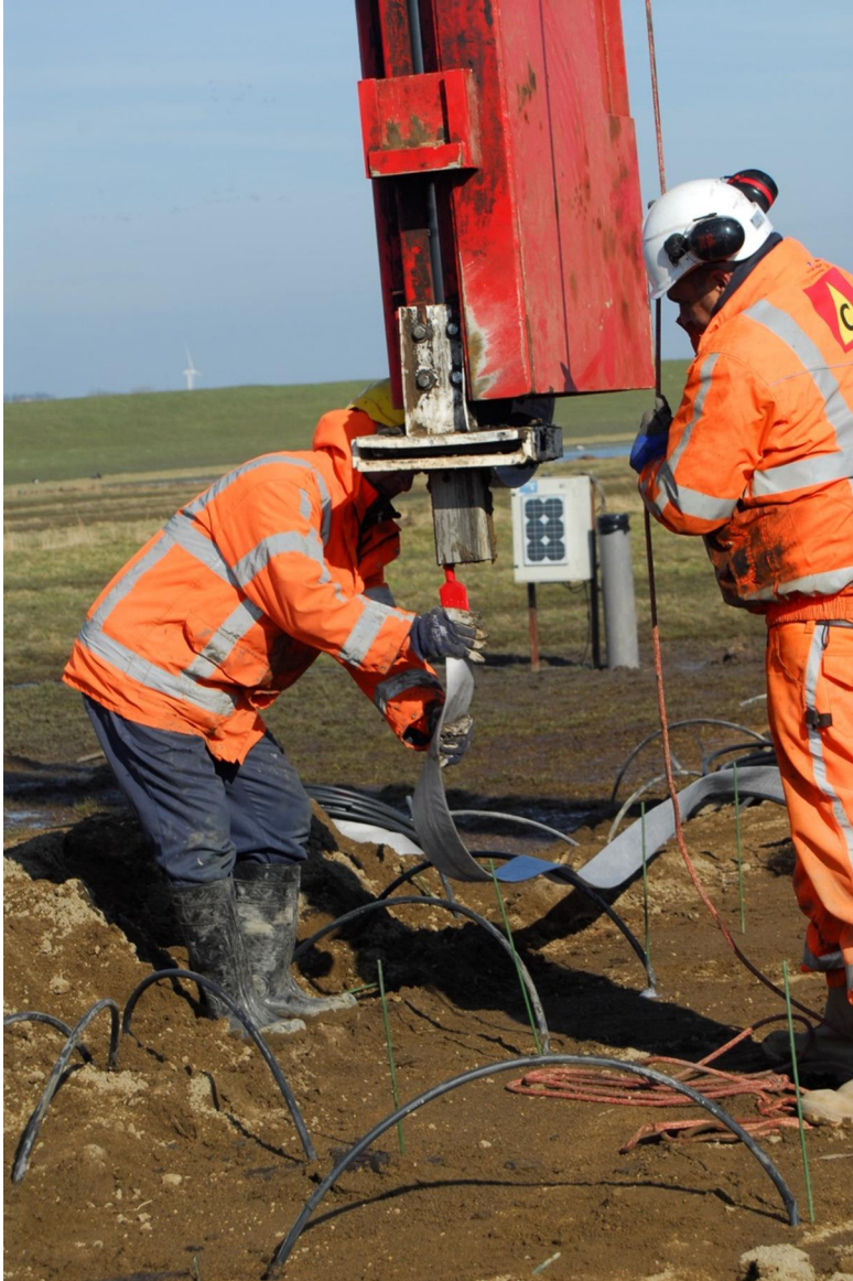
Figuur 3.18 De geprefabriceerde drains worden in de makelaar getrokken en daarna op diepte weggedrukt
