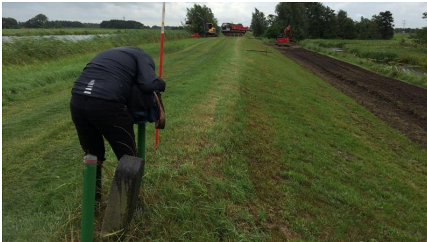
Figuur 1. Reparatie van scheuren in een veendijk langs de Enkele Wiericke (foto: www.nos.nl ).
