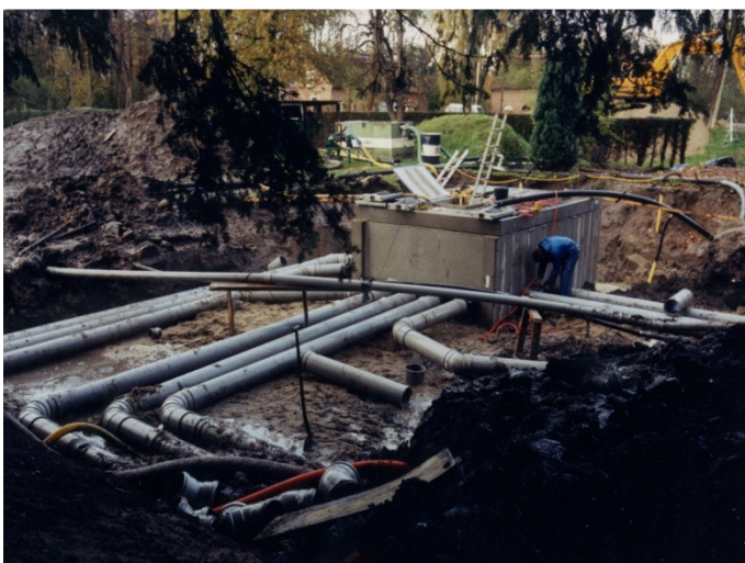
Afbeelding 3.4 Aansluiting verzamelleidingen op verzamelput in Jaarsveld (foto: HDSR)
