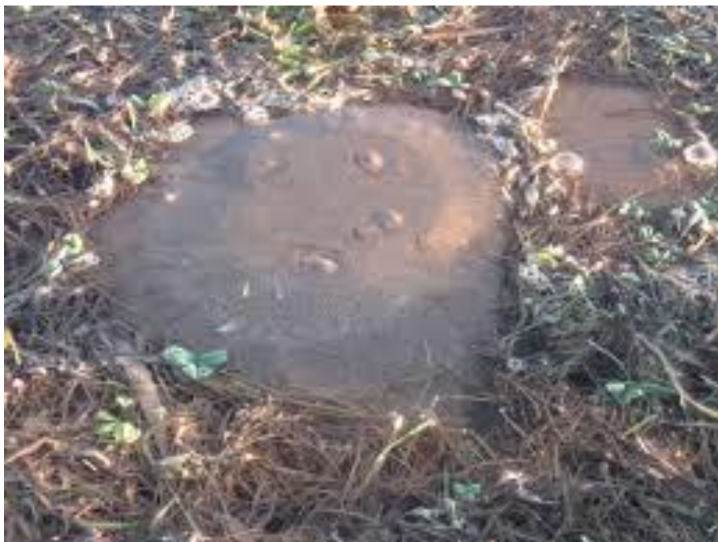
Figuur 14. Plek met opkwellend water achter de dijk bij Zalk ten gevolge van piping tijdens hoog water op de IJssel. Soms zijn de wellen, die bij aanhoudend hoog buitendijks water opborrelen, beperkt van omvang, maar ze kunnen aanzwellen tot uiteindelijk een stuk dijk helemaal verzwakt raakt.
