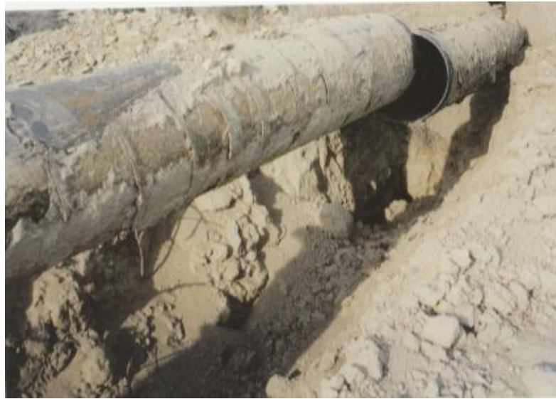
Figuur 4-4 Gescheurde rondlas ten gevolge van grondverzakking door mijnbouw (ref. 9)
