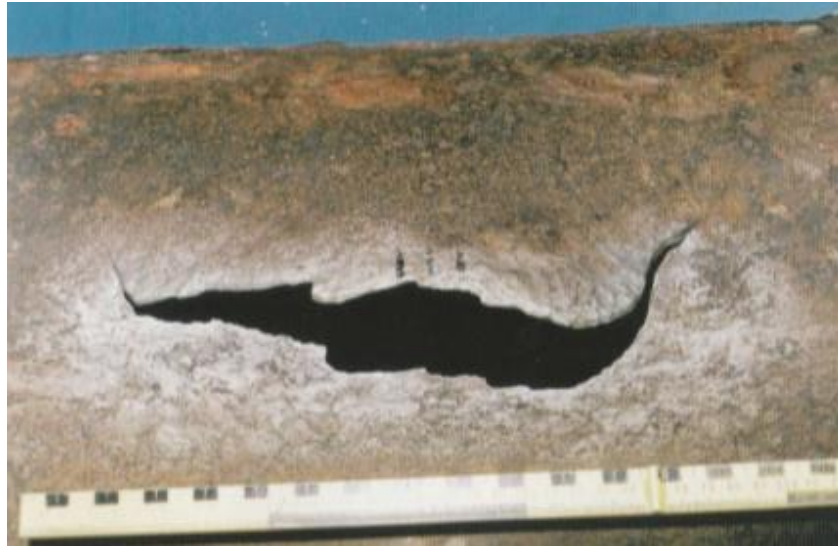
Figuur 4-2 Bezweken cluster corrosieplekken, geen instabiele breuk [Macaw (2003)]
