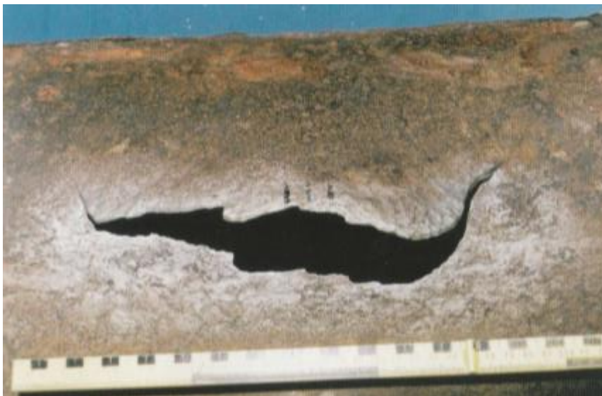
Fig. 1 – Bezweken cluster corrosieplekken, geen instabiele breuk (ref. 9 )
