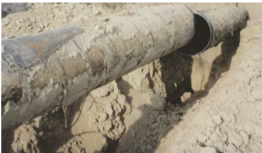
Fig. 3 – Gescheurde rondlas ten gevolge van grondverzakking door mijnbouw (ref. 9)
