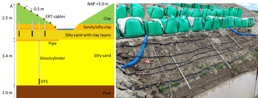
Figuur 2-15: Links: Dwarsdoorsnede met de positie van de ERT-kabels langs het talud ten opzichte van de sloot en de pipe. Rechts: De kabels zijn zwart en de elektrodes (haringen zijn zichtbaar langs de kabels).
