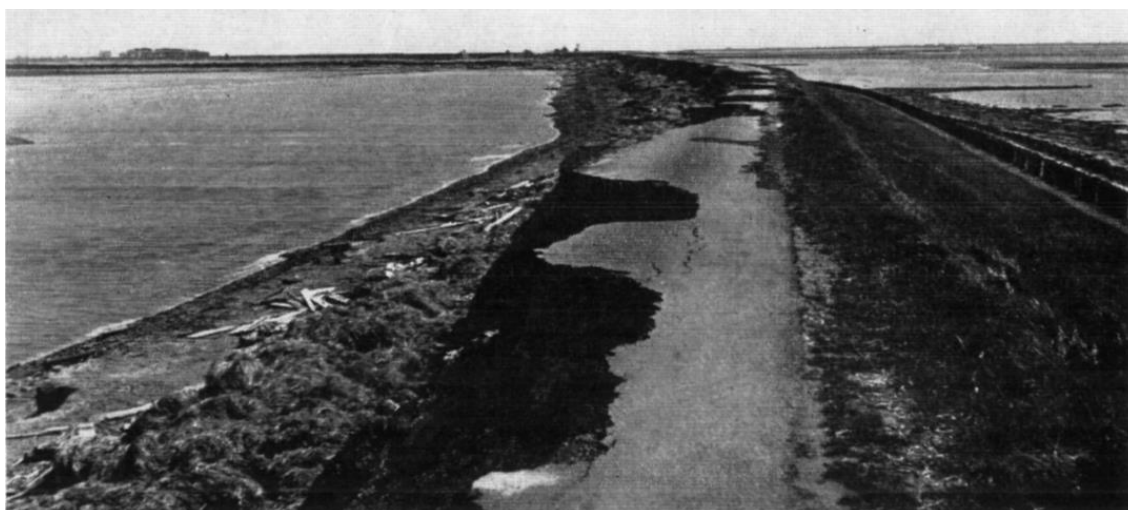
Figuur 2-3: Beschadigde dijk (polder Vierbannen, Duiveland) als gevolg van erosie ten tijde van de watersnoodramp in 1953.
