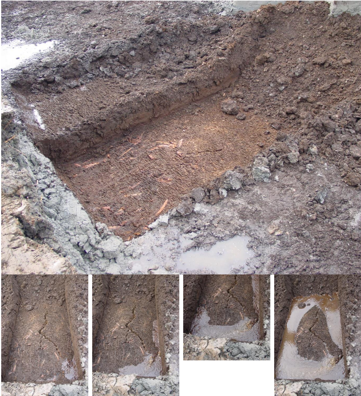
Figuur 2-2: Beeldmateriaal van het fenomeen opbarsten (bron: Arcadis beeldbank), zichtbaar is dat scheuren groter worden en dat de grond omhoog beweegt, water stroomt door de scheur.
