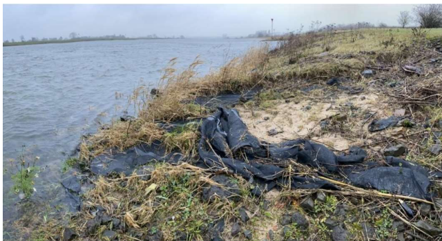
Figuur 2.6. Voorbeeld degradatie geotextiel in oeverbescherming (Witteveen+Bos, 2022)
