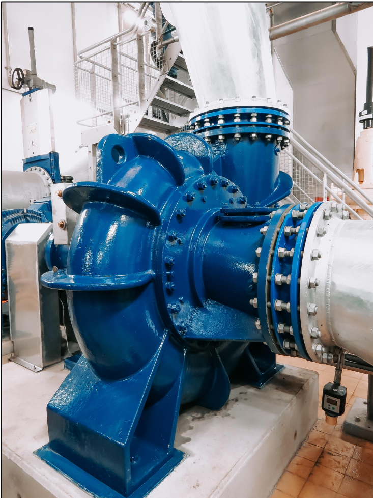
RWX1-500.735 (Xcentric) in gemaal Damsterdiep
