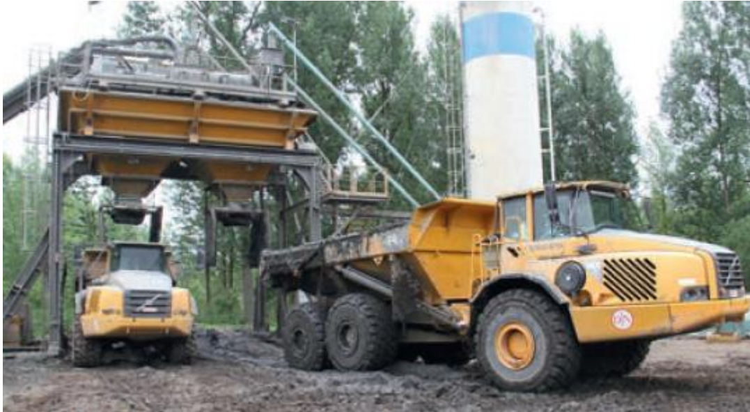
Figuur 3-9: Toevoegen van kalk toegepast bij dijk Vlassenbroekse polder (Terra et Aqua 138, 2015)
