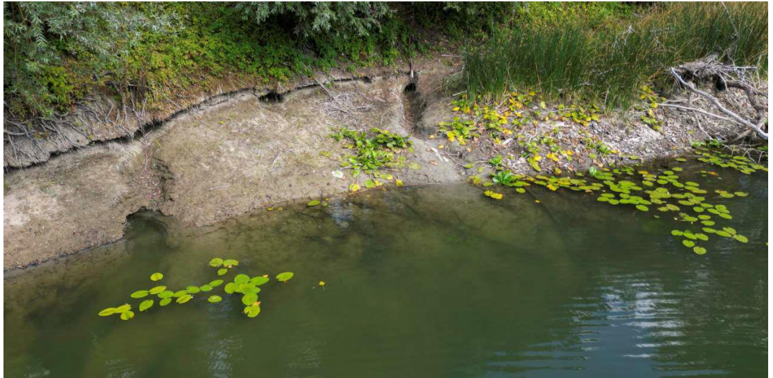
Figuur 2.15 Drooggevallen toegangen van beverholen in de oever van het wiel, aan de kant van de dijk (Kapinga, 2022).
