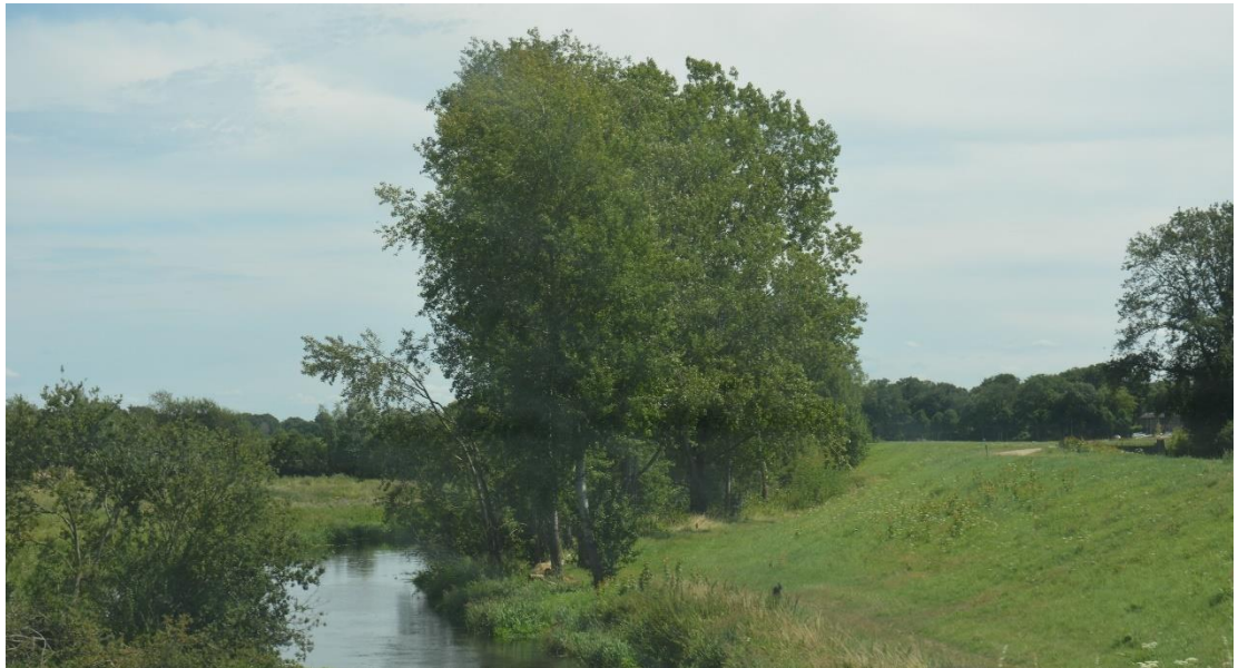
Figuur A.3 Niersdijk met veel vegetatie in de teen van de dijk. Hier is ook een aantal bevergraverijen waargenomen.
