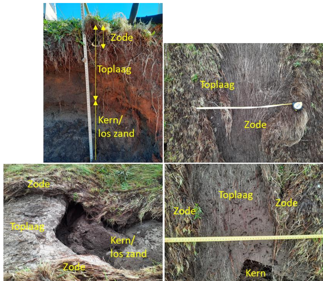
Figuur D.2 Illustratie schade en doorbraak van de toplaag op de Vechtdijk, onderscheid tussen zode, toplaag en kernmateriaal (zode is onderdeel van de toplaag). Linksboven: toplaag doorgebroken; rechtsboven: schade; linksonder: toplaag doorgebroken; rechtsonder: toplaag doorgebroken.
