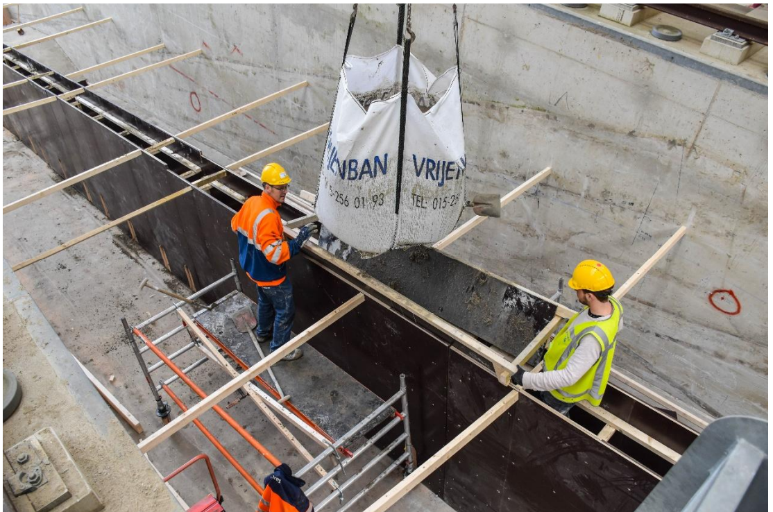
Figuur B.9 De middenwand wordt gecentreerd met tijdelijke balken aan weerszijden en vervolgens volgstort met zandcement.
