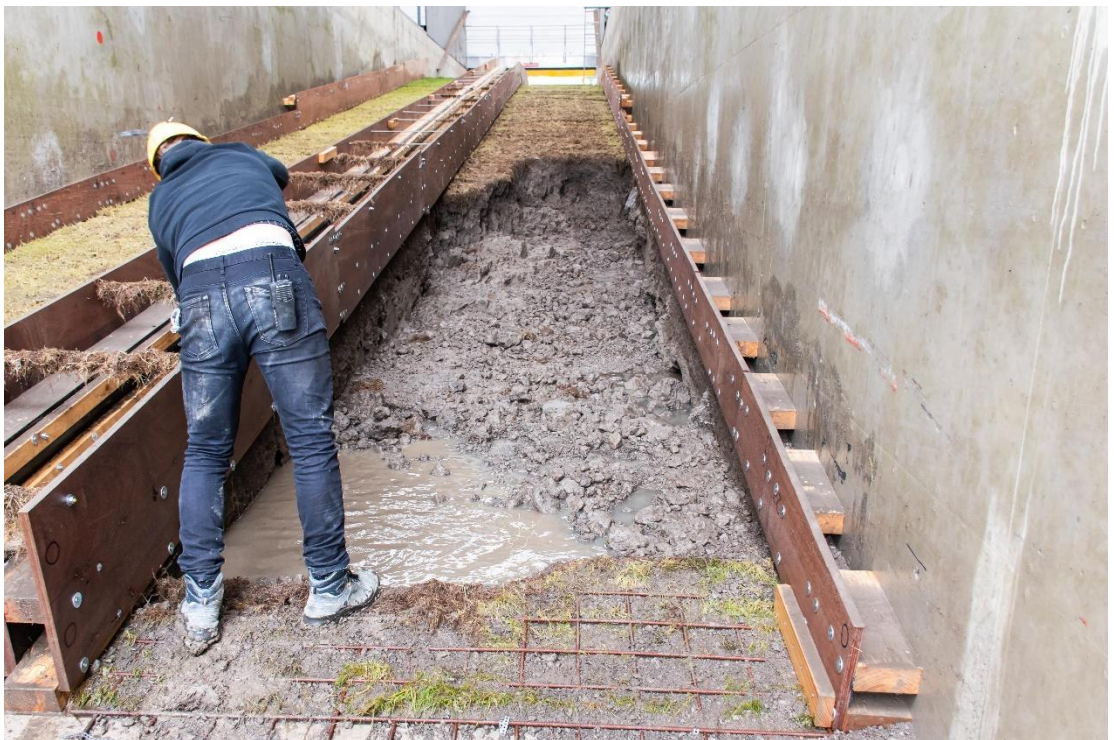
Figuur B.122 De erosieklijf is ondanks de lagere golven toch een stuk richting de kruin gegroeid.
