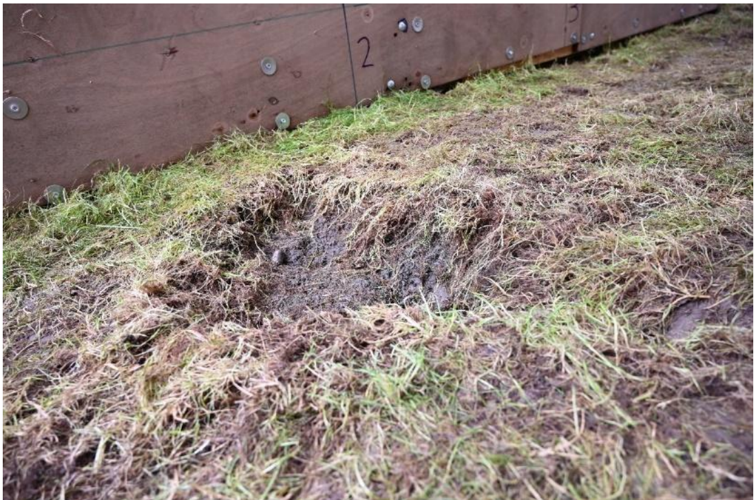
Figuur 5.3 Gat in het gras van de Dollarddijk na proef B2_05 rond X' = 1,5 m
