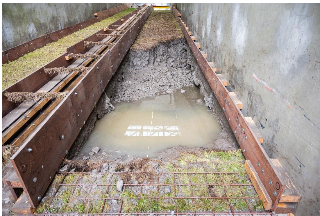
Figuur B.117 Erosie aan de Dollardzijde na proef B2_08. De erosie is verder gegroeid richting de kruin.
