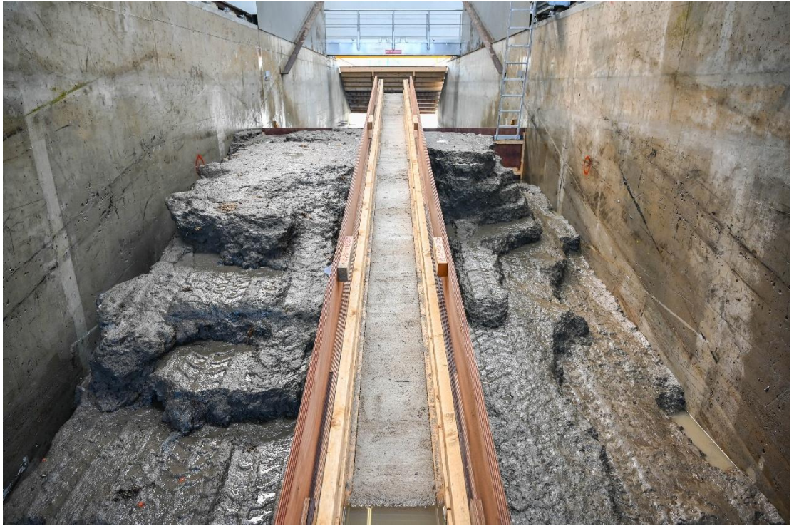
Figuur B.83 Klei-erosie hoog op het talud na proef B1_16. Kruin van de Valgenweg kant is doorgebroken.
