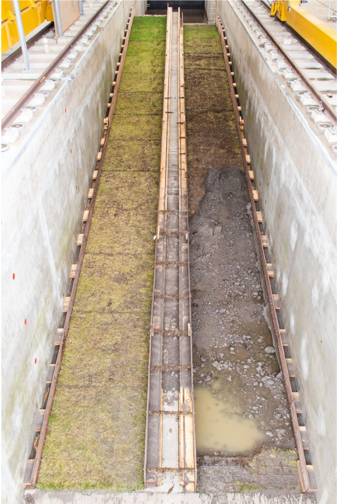
Figuur B.123 Erosiekuil aan de Dollardzijde is gegroeid tijdens proef B2_10. Er is geen erosie aan de Blijzijde.
