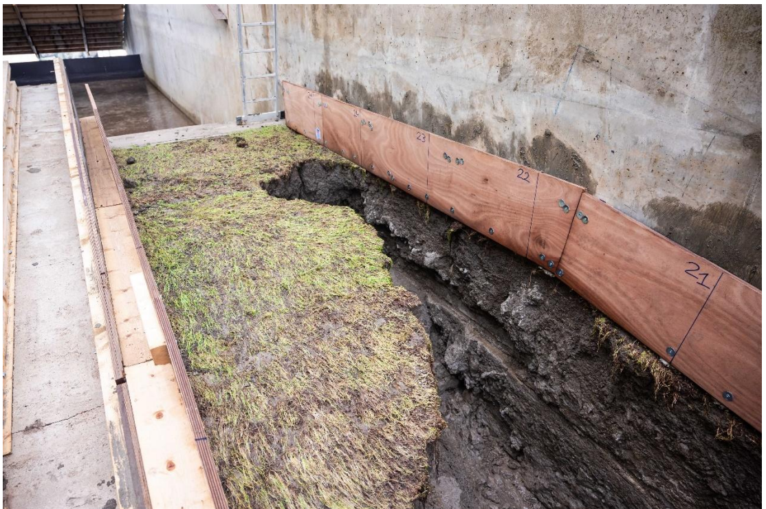
Figuur B.133 De erosie is tijdens proef B2_13 doorgesleed in de kruin aan de Dollardzijde.
