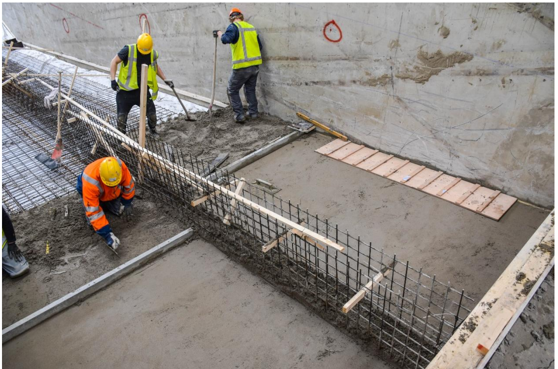
Figuur B.5 Het storten en afwerken van de zandcement vloer van 25 cm dikte.
