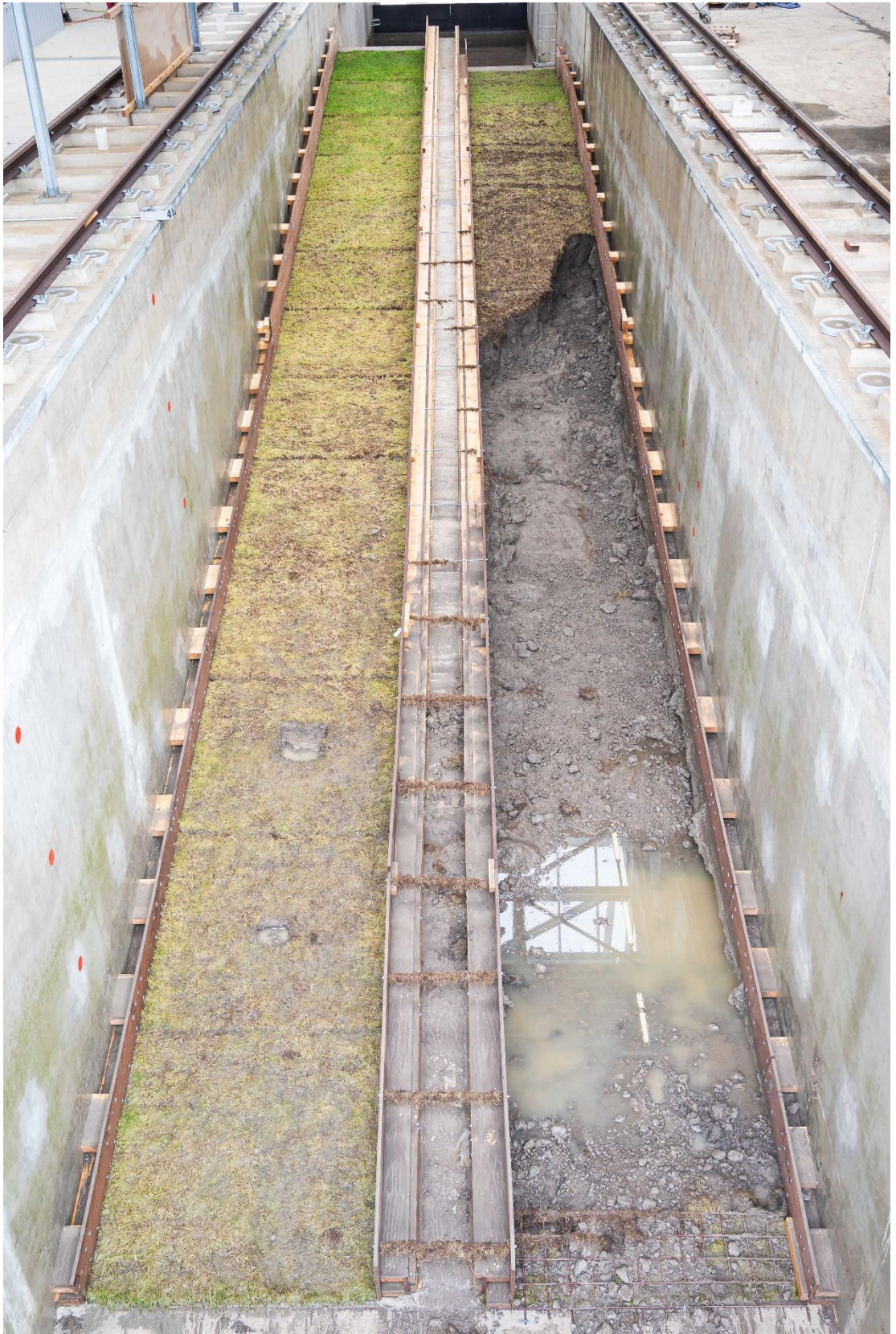
Figuur B.126 De erosie aan de Dollardzijde is snel omhoog gegroeid. Aan de Blijzijde is geen erosie.
