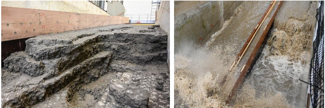
Figuur 4.5 Klif aan de Valgenwegkant na test B1_07 met laagsgewijze erosie (links) en klif zichtbaar tijdens proef B1_10 (rechts).
