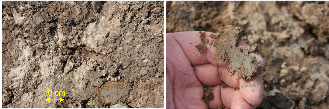
Figuur 6.9 Plaatselijke plekken met sterk zandige klei in de klei van de Dollarddijk (lichte plekken in de linker foto bevatten veel zand in de klei; zo'n zandige plek is in rechter foto tussen de vingers uitgesmeerd) (naar het oosten toe werd het steeds zandiger)
