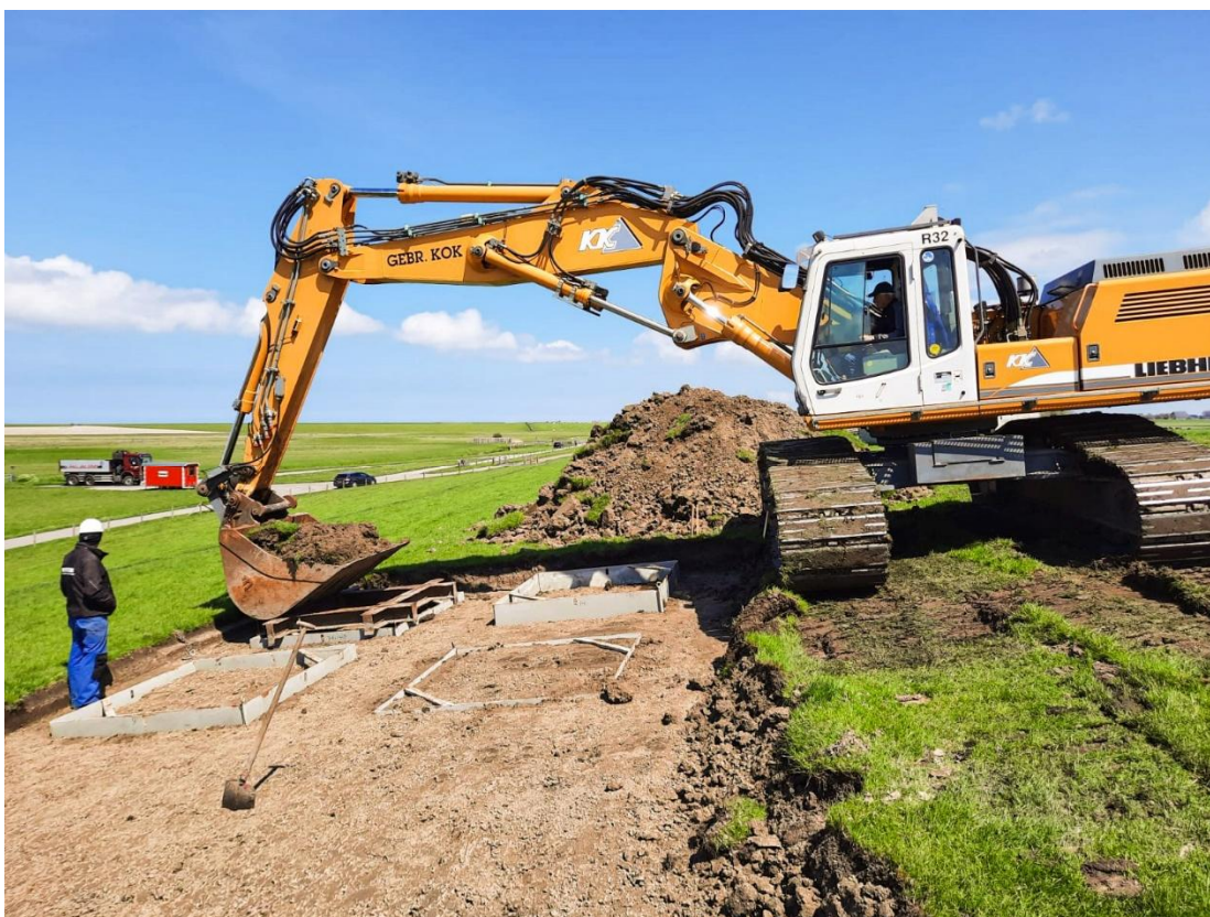
Figuur B.87 Drukken van stalen mallen in de dijk bij Blija. De grasmat is hier eerst afgegraven waarna de onderblokken gestoken zijn.
