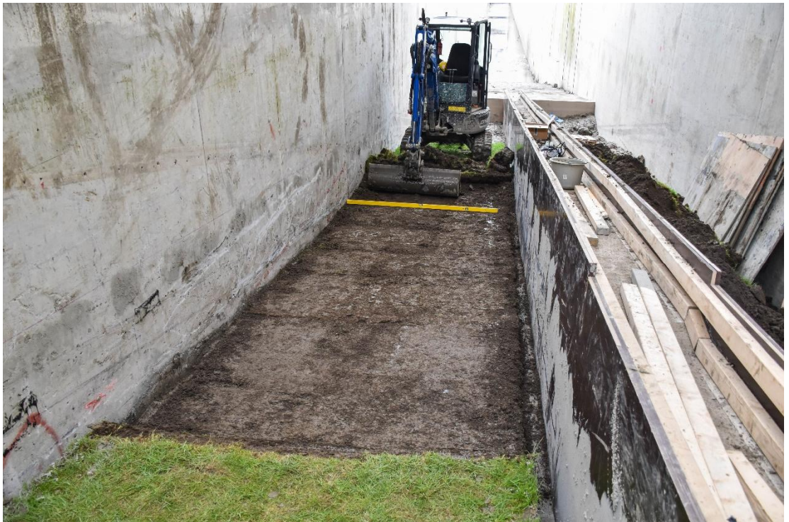
Figuur B.95 Afgraven van de bovenste 30 cm van de onderblokken uit de Dollarddijk. Hierbovenop zijn de bovenblokken geplaatst.
