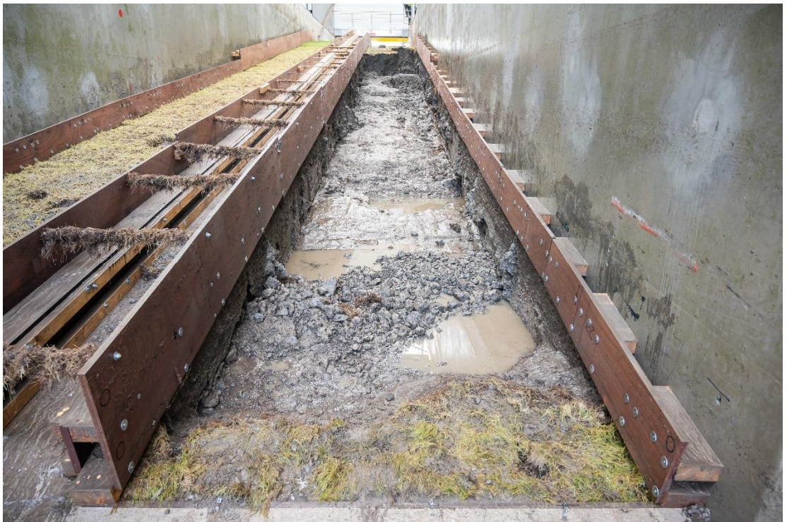
Figuur B.130 Erosie aan de Dollardzijde na proef B2_12.
