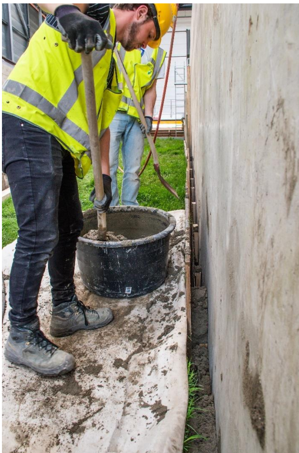
Figuur B.97 Storten van zandcement tussen het kleiblok en de gootwand om het blok naadloos in te bouwen.
