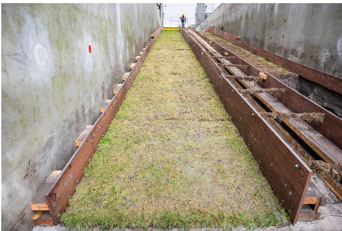
Figuur B.115 Er is nog geen erosie aan de Blijzijde na proef B2_07.
