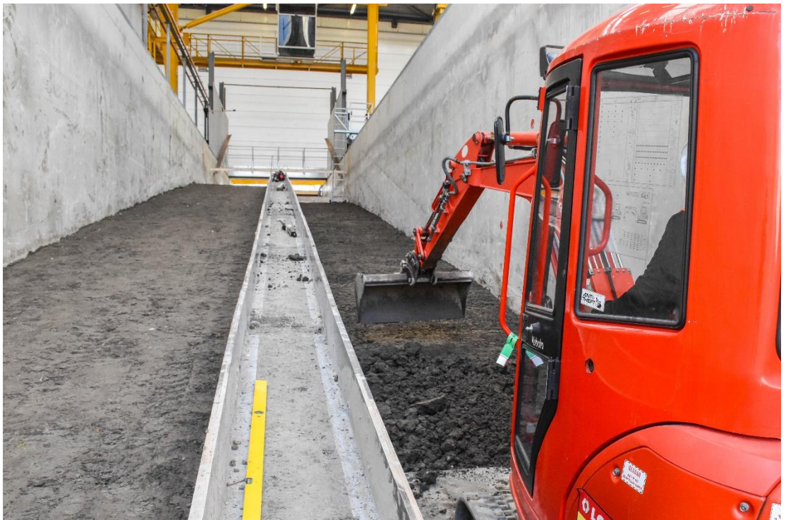
Figuur B.17 Nadat de Valgenwegklei voldoende was gedroogd, is deze aan de rechterkant (gezien vanaf het golfschot) aangebracht.
