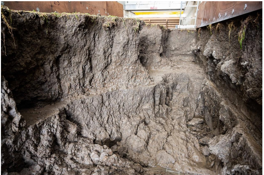
Figuur B.138 Zijkant van de blokken uit de Dollarddijk waarbij de brokkelige structuur goed te zien is.
