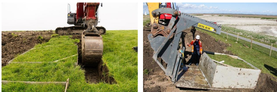
Figuur 3.11 Ontgraven van de gedrukte mal (links) en het eronder schuiven van de bodemplaat (rechts)
