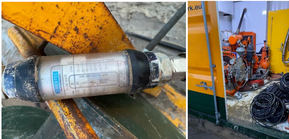
Figuur 6 Debietmeter (Webtec no. 4,986,133) links en pompstation rechts.
