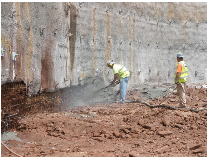
Figuur 2-3: Constructie van een facing bij een vernagelde grondconstructie. Hier is sprake van een verticale wand, deze versterkt middels vernageling. De ankers inclus ankerplaten steken uit het grondlichaam. Deze worden overgespoten met spuitbeton met een laagdikte van 3 á 4 inch (7,5 á 10 cm). Bron: Soil Nail Walls Reference Manual, blz. 57.
