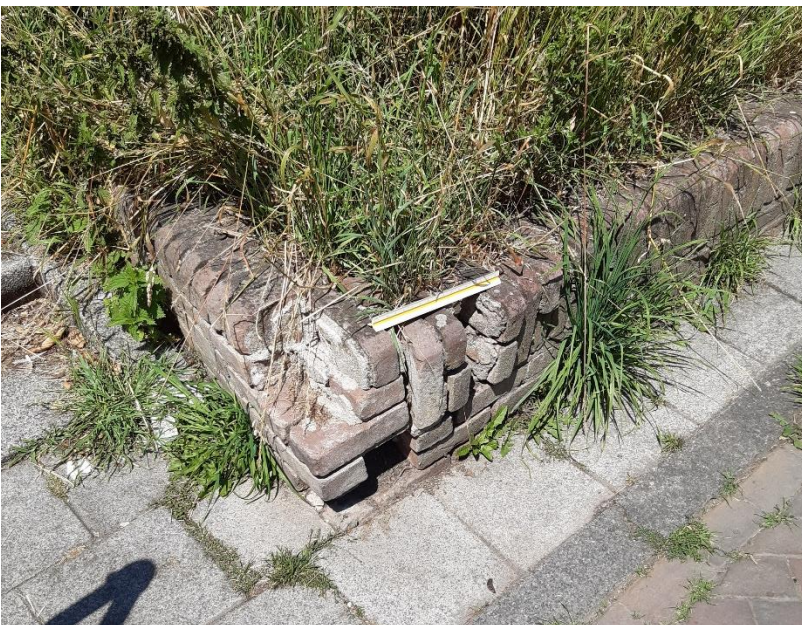
Figuur 8: Schade aan binnendijks keerwandje, ontbreken van een aantal stenen
