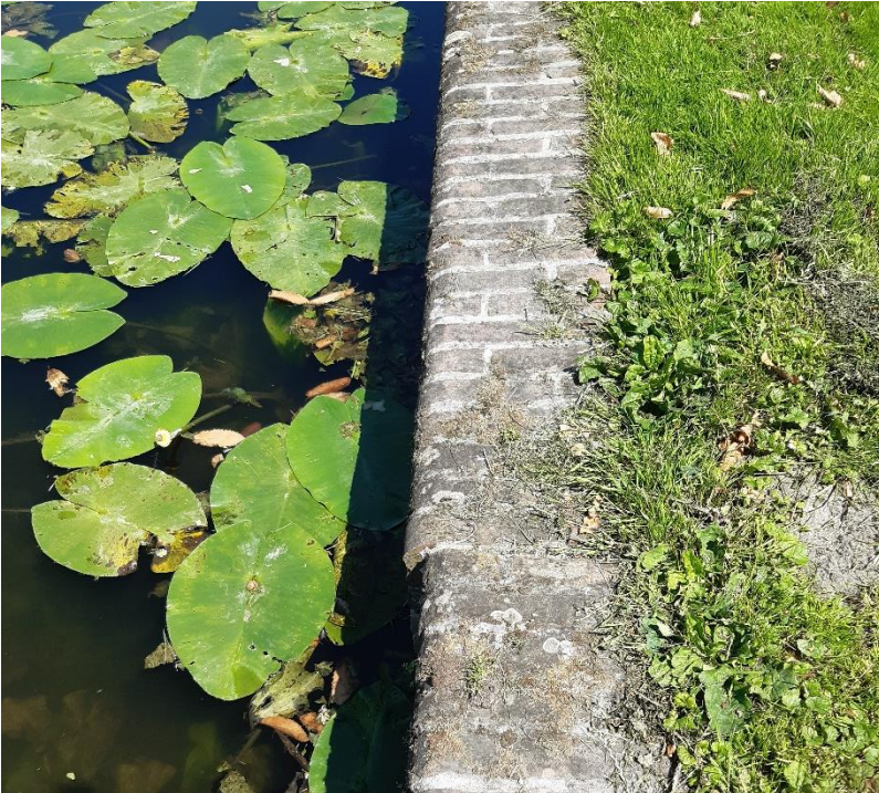
Figuur 7: Deformatie tussen verschillende segmenten van de kademuur langs het buitenwater.
