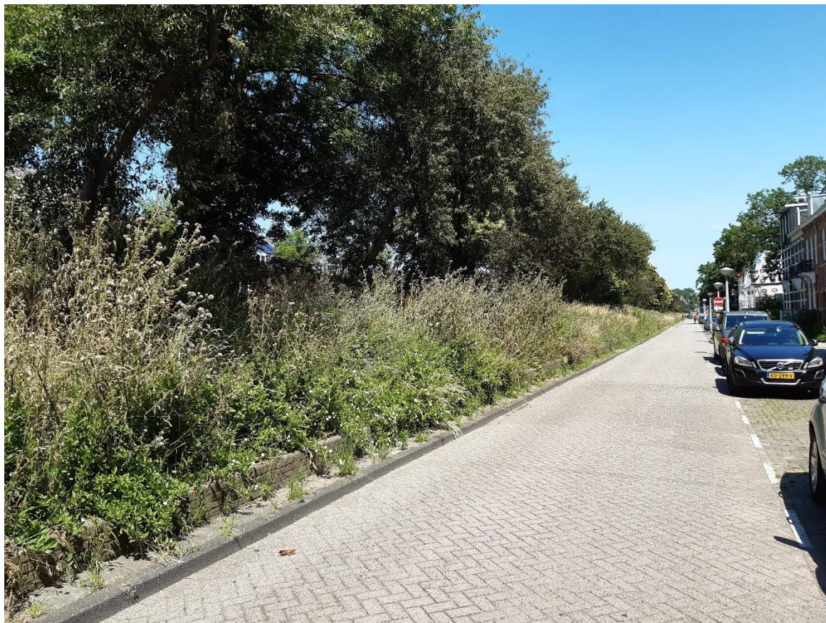
Figuur 1: Algemeen beeld van de Ringdijk, veel begroeiing op het talud
