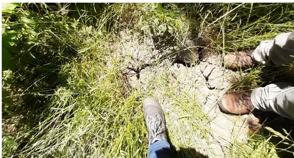
Figuur 2: Droogte scheuren in het talud ter hoogte van de kopplaten.
