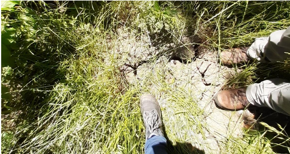
Figuur 3-1: Droogte scheuren in het talud ter hoogte van de kopplaten.
