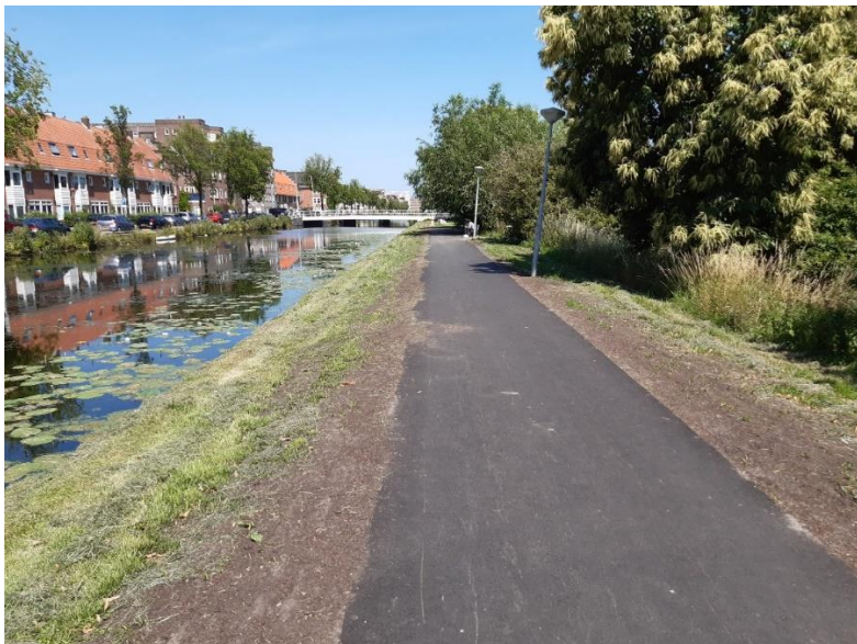
Figuur 5: Gras ontbreekt langs het fietspad, dit betreft de berm afwerking, of een mestmengsel op het bestaande gras.
