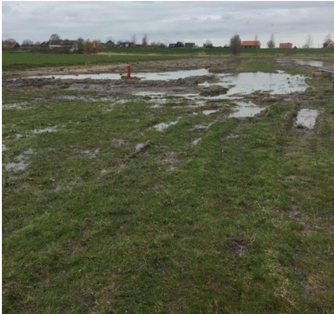
Figuur 3-5 Impressie schadebeeld (1-3)
