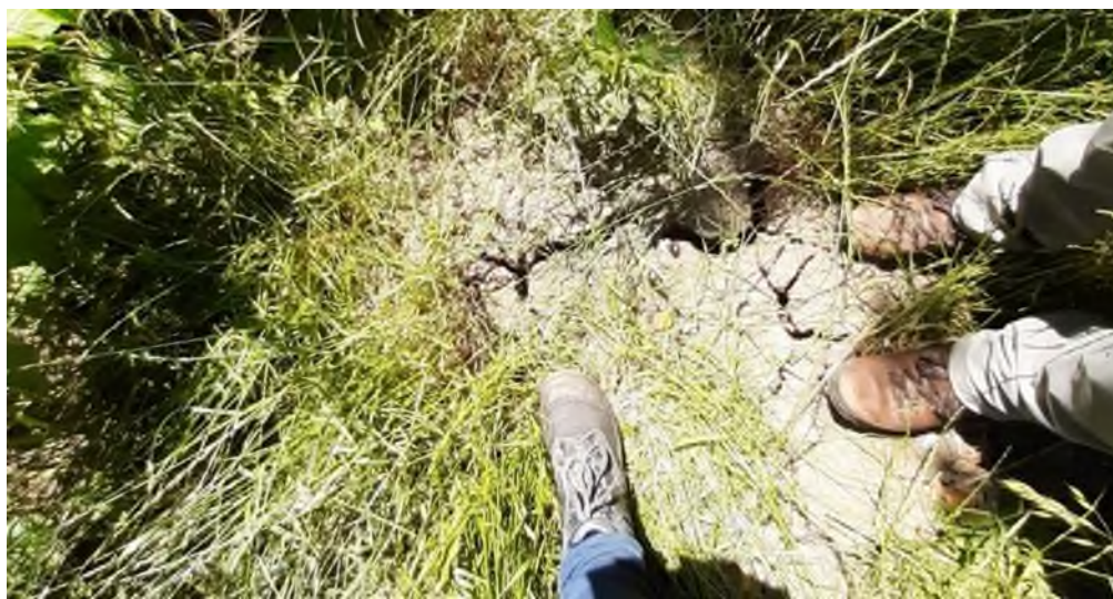
Figuur 4-1: Droogte scheuren in het talud ter hoogte van de kopplaten.
