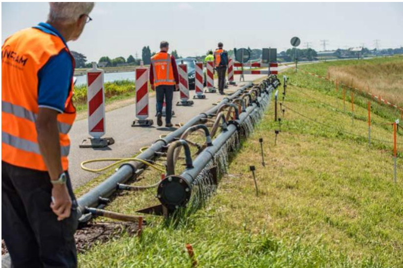
Figuur 2.3 Infiltratieproef als proefbelasting op de Groenendijk te Nieuwerkerk aan den IJssel
