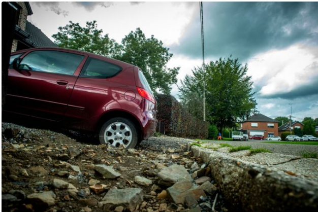
Les ouvriers de Plombières sont intervenus à Dolhain, sans oublier les dégâts chez eux. ©EdA LABEYE Philippe
