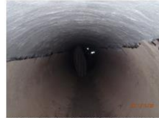
Betonnen leidingen die inwendig dienen te worden voorzien van een duurzame bescherming.
