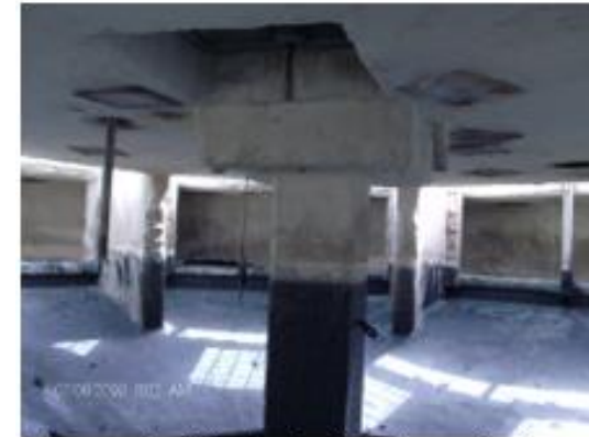
Betonnen hoofdverdeelwerk dat inwendig dient te worden voorzien van een duurzame bescherming.
