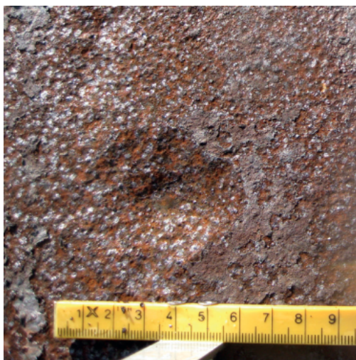
Figuur S1.3 Voorbeeld van putcorrosie met daaromheen uniforme corrosie
