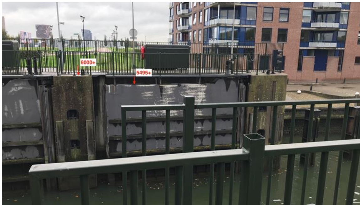
Figuur 2-4: Foto met illustratie hoogtes van sluisdeuren en constructie o.b.v. tekening [tek DT204_43_2001]
