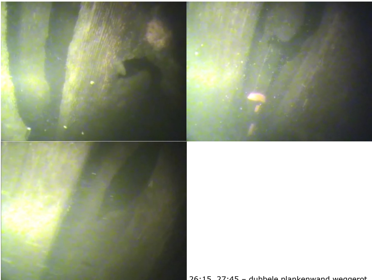
26:15, 27:45 – dubbele plankenwand weggerot
