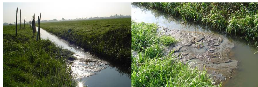
Foto's: Wel 1 in Polder de Noordplas. De zandophoping in de sloot is ontstaan na het uitvoeren van een prikstokmeting waardoor een nieuwe uitstroomgat van de wel is ontstaan
